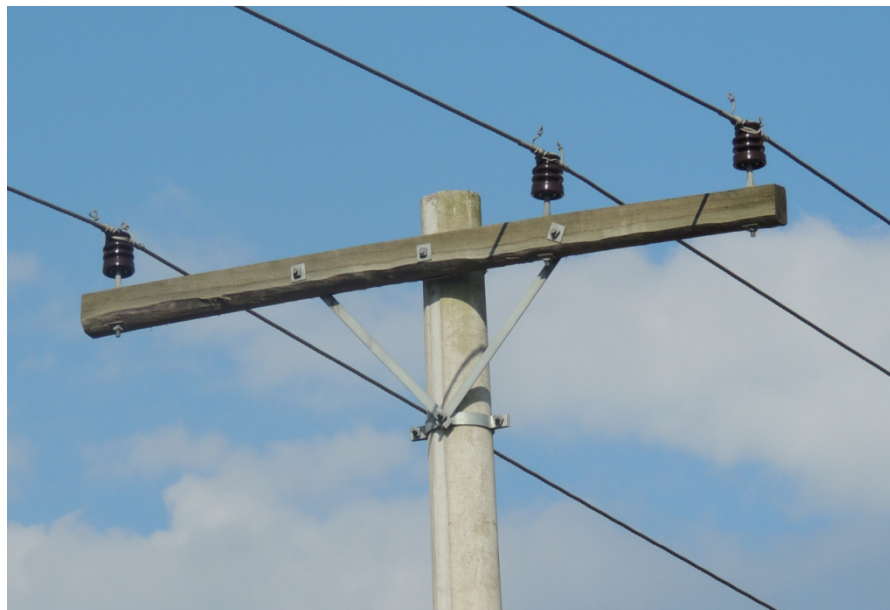
Figura 4 – Foto de rede aérea com condutores singelos em estrutura tipo N.
