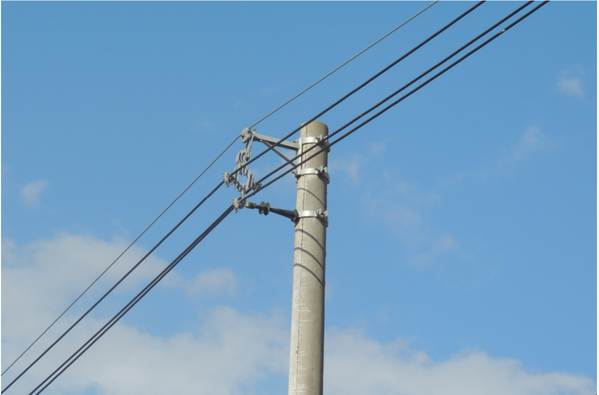
Figura 8 - Foto de rede compacta protegida 15kV.
