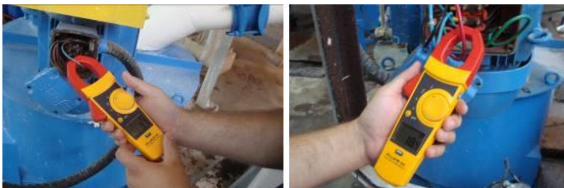
Figura 7 – Realização de medições de corrente dos motores elétricos das bombas BTA1 e BTA2.
