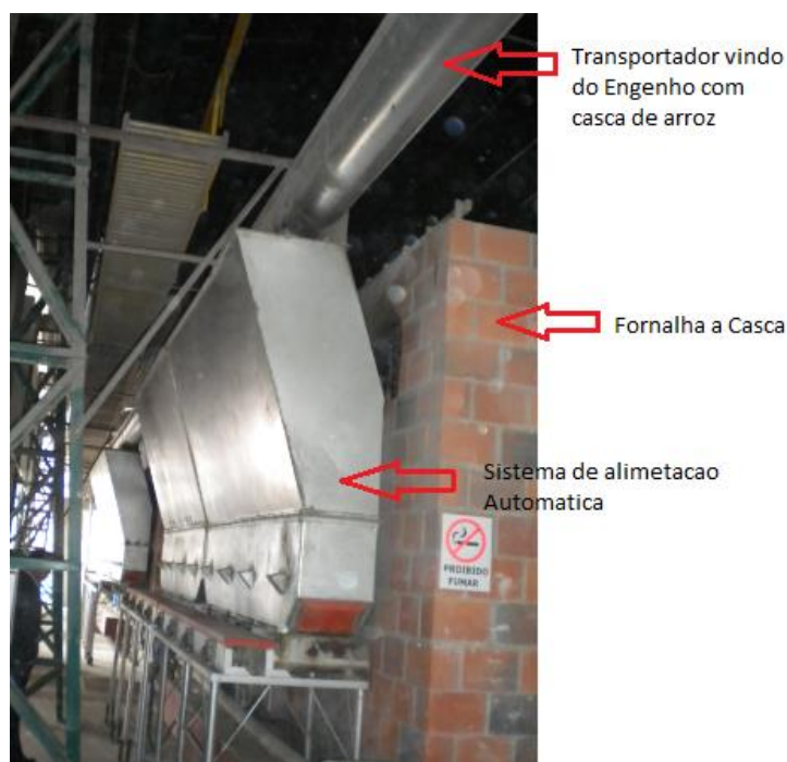
Figura 3 – Alimentação de Casca na Fornalha
