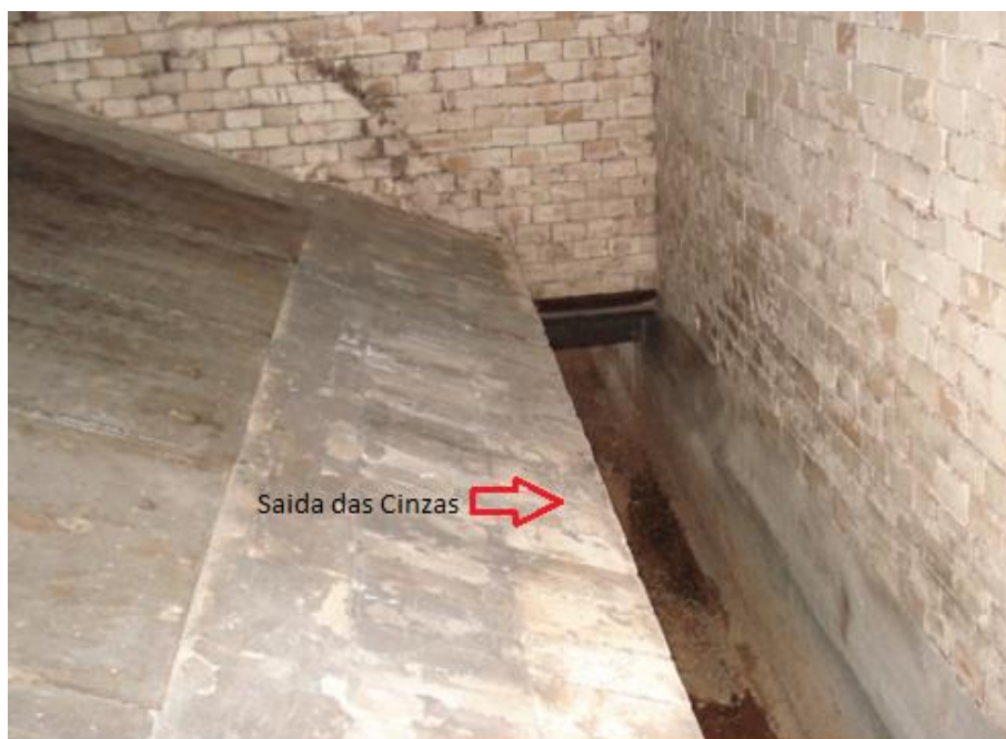
Figura 8 – Saída de Cinzas na Fornalha Fonte: A Autora (Kepler Weber- fabricante)
