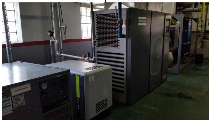
Figura 17: Sala de geração de ar comprimido, compressor GA 37 +FF
