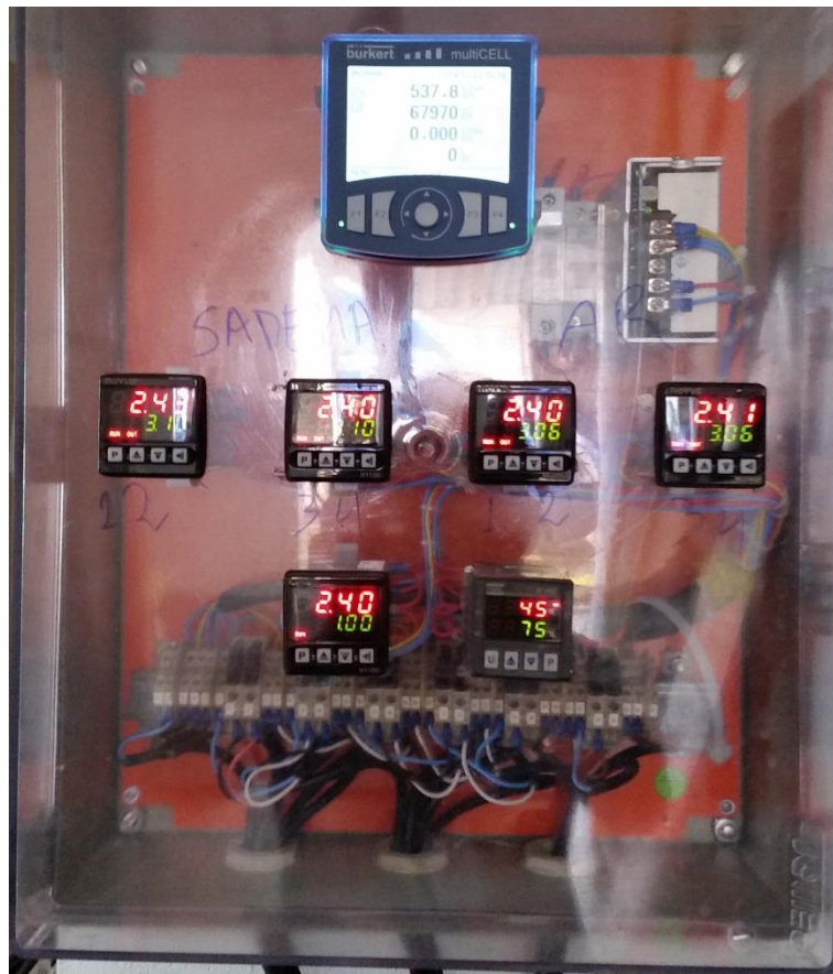
Figura 14: Sistema de controle de nível e hidrômetro.
