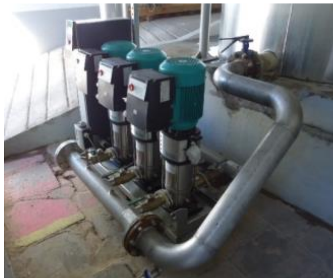
Figura 13: Sistema de bombeamento.
