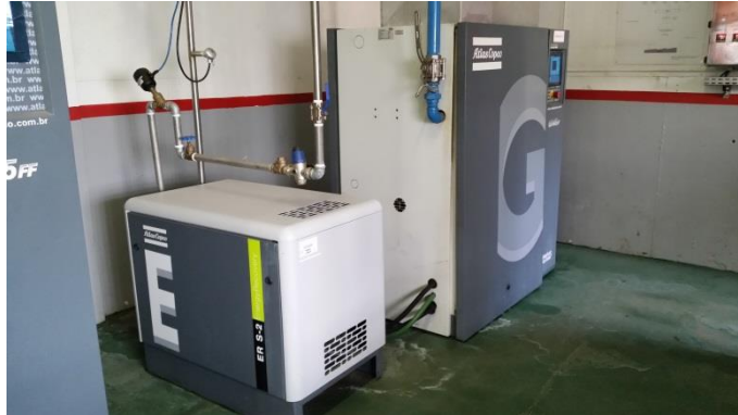
Figura 16: Sala de geração de ar comprimido, compressor GA 45.
