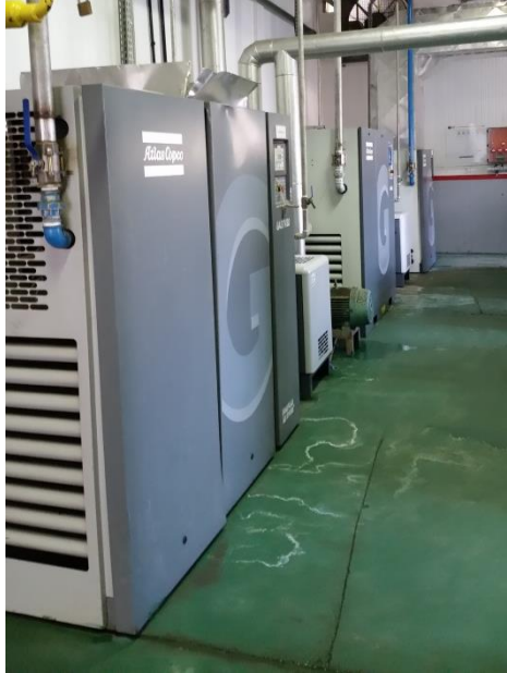
Figura 15: Sala de geração de ar comprimido.
