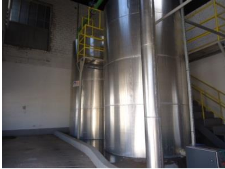
Figura 12: Tanques termo acumuladores.
