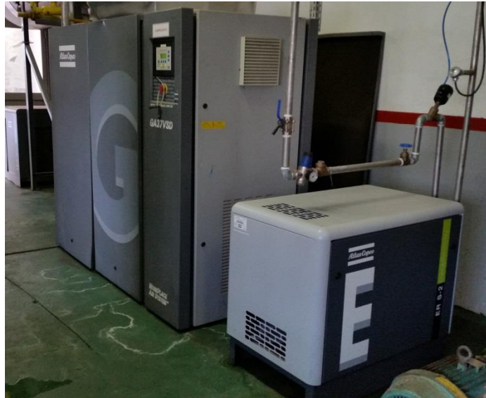
Figura 18: Sala de geração de ar comprimido, compressor GA 37 VSD
