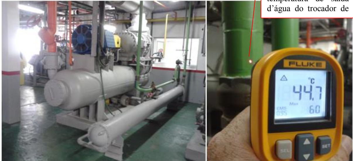
Figura 32 – Verificação de temperatura d'água no Compressor MYCOM N250-VMD-TS Fonte: Autoria própria do autor.
