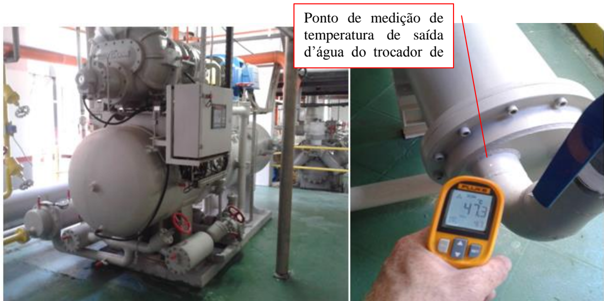
Figura 33 - Verificação de temperatura d'água no Compressor MYCOM N320-VSD-TS Fonte: Autoria própria do autor.
