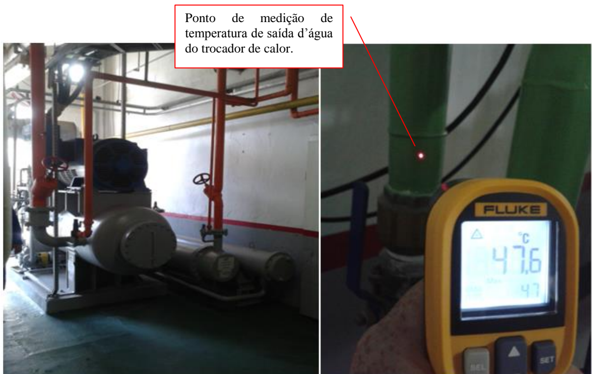
Figura 35 – Verificação de temperatura d'água no Compressor MYCOM N320-SUMX
