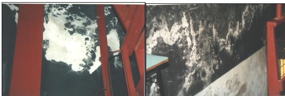
FIGURA 19 – Manchas de umidade nas paredes laterais do palco (2004). Fonte: Arquivo do autor.
