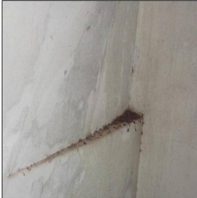
Figura 10 – Fezes de Morcego na Parede, Prédio 20. Fonte: Arquivo Pessoal da Autora.
