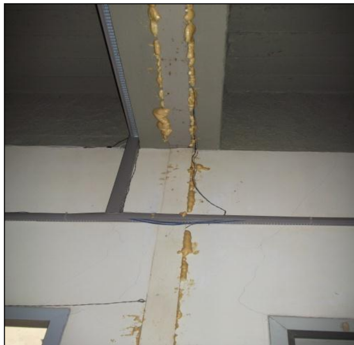
Figura 5- Junta de Dilatação do Lado Interno, Prédio 17. Fonte: Arquivo Pessoal da Autora.
