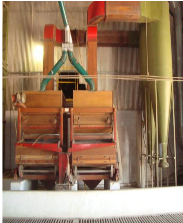
Figura 7 - Fotografia - Máquina KW 15 – Equipamento da COTRISEL – Unidade de Restinga Sêca. Fonte: Arquivo pessoal, 2009.
