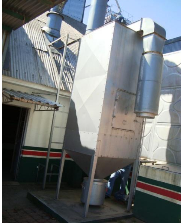
Figura 8 - Fotografia – Filtro de Mangas – Equipamento da COTRISEL – Unidade de Restinga Sêca. Fonte: Arquivo pessoal, 2009.
