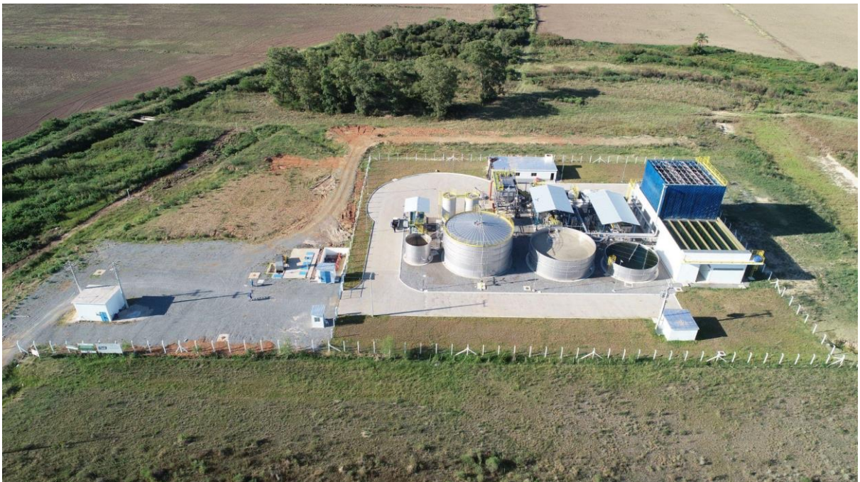
Figura 4. Estação de Tratamento de Água e construção da Estação de Tratamento de Esgoto Vacacaí
