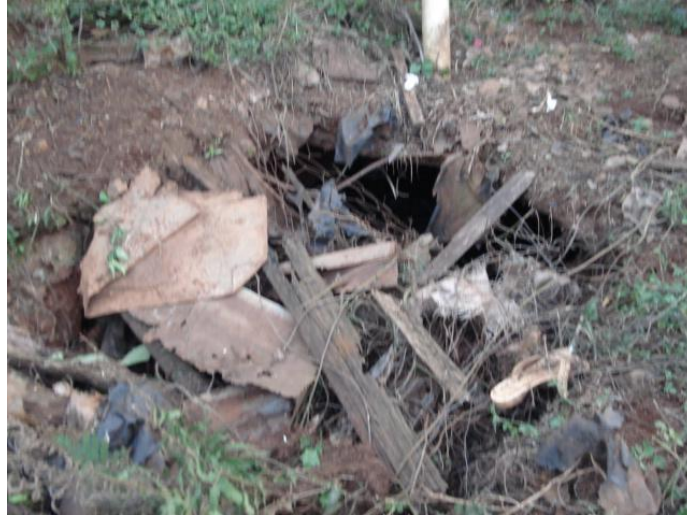
Figura 11 – O dano – o poço negro estourado. Fonte: arquivo da autora.
