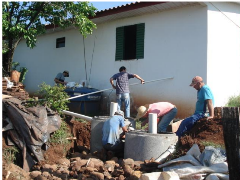
Figura 12 – O reparo – reator anaeróbico com recheio de bambu sendo implantado. Fonte: arquivo da autora.
