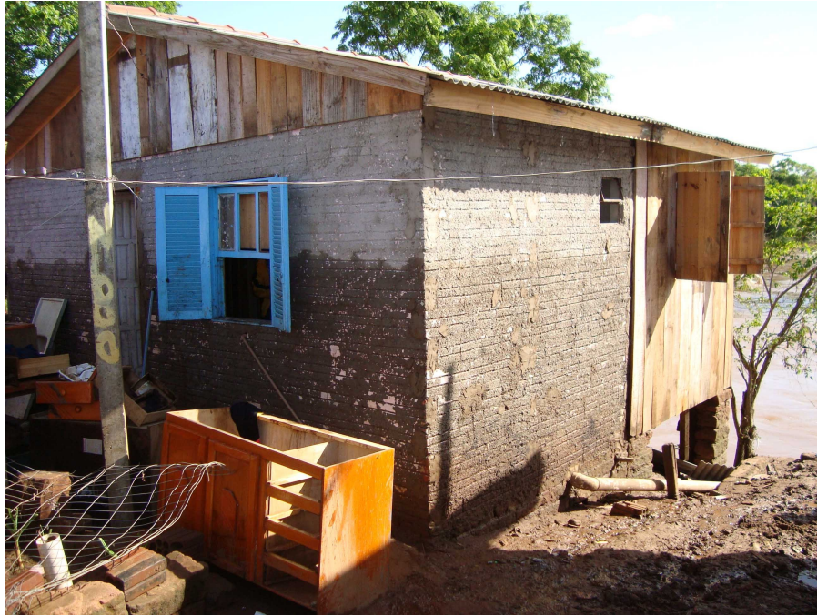
Figura A2 – Casa de morador ribeirinho atingido pela enchente do rio Paranhana. Fonte: Secretaria Municipal de Meio Ambiente de Parobé.
