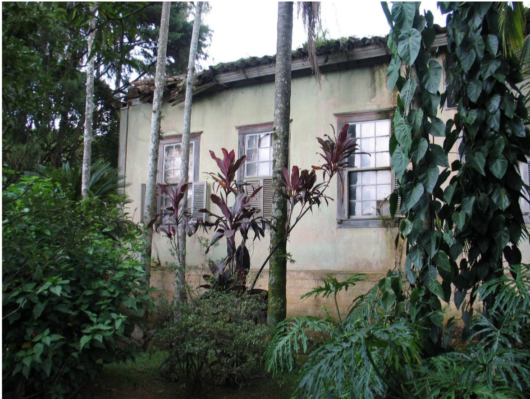
Figura 1 - Fazenda Refúgio, São João da Boa Vista (SP): edificações abandonadas, em avançado estágio de deterioração, em terras arrendadas para grandes empresas produtoras do setor sucroalcooleiro. Fonte: fotografia de Vladimir Benincasa, 2008.
