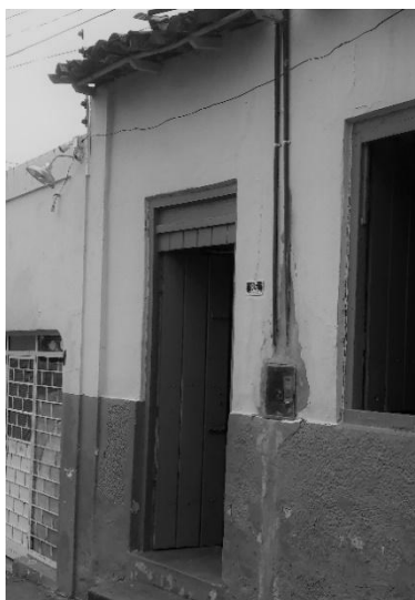
Figura 1 - Edificações com Beiral de Cachorro, em um trecho da Rua Praça do Rosário. Fonte: Os Autores, 2019.
