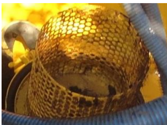
Figura 43 - Crivo interno - Subsistema Distribuidor
