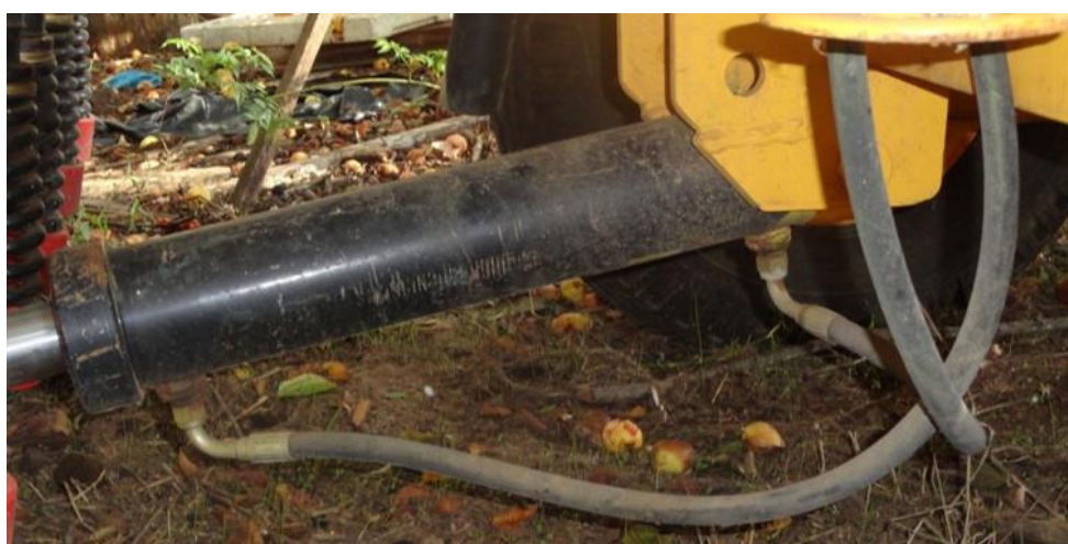
Figura 36 - Posição original das mangueiras no pistão hidráulico.
