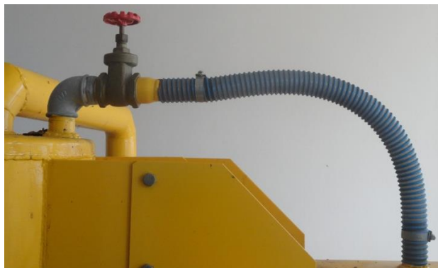
Figura 21 - Tubulação de retorno - Registro
