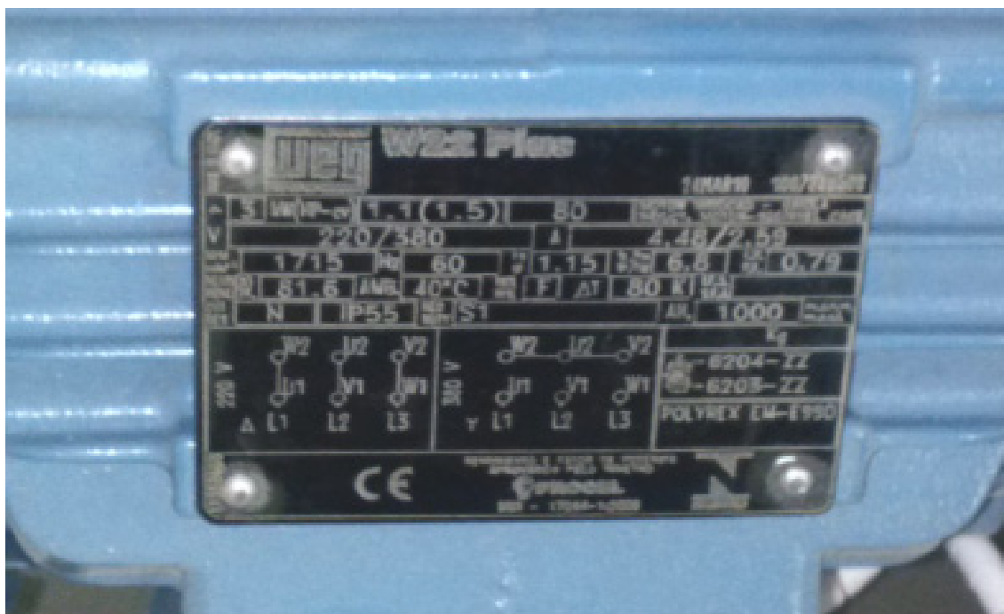
Figura AN-3.4 – Máquina de indução utilizada experimentalmente – Detalhe da placa de identificação.
