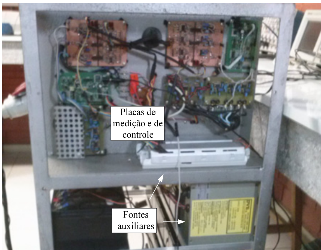
Figura AN-4.3 – Placas de medição de tensão e corrente, placas de controle (DSP) e fontes auxiliares.
