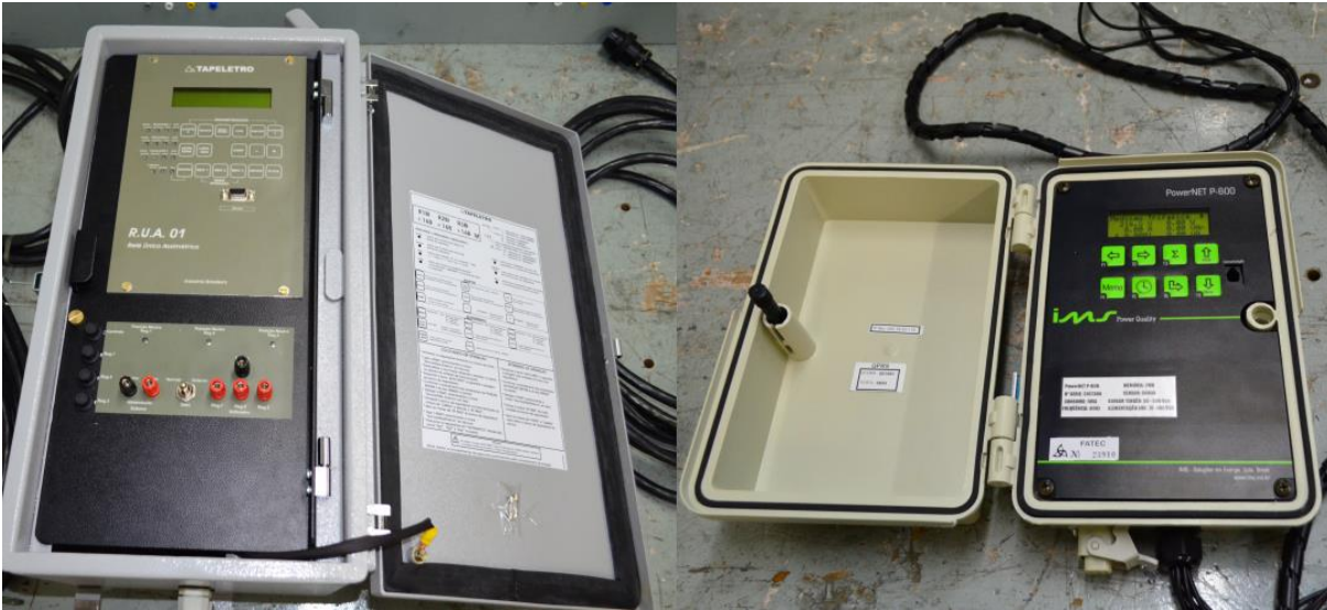
Figura 6.11 - Fotos dos equipamentos utilizados: um controlador de reguladores de tensão (E) e um medidor de qualidade de energia (D).
