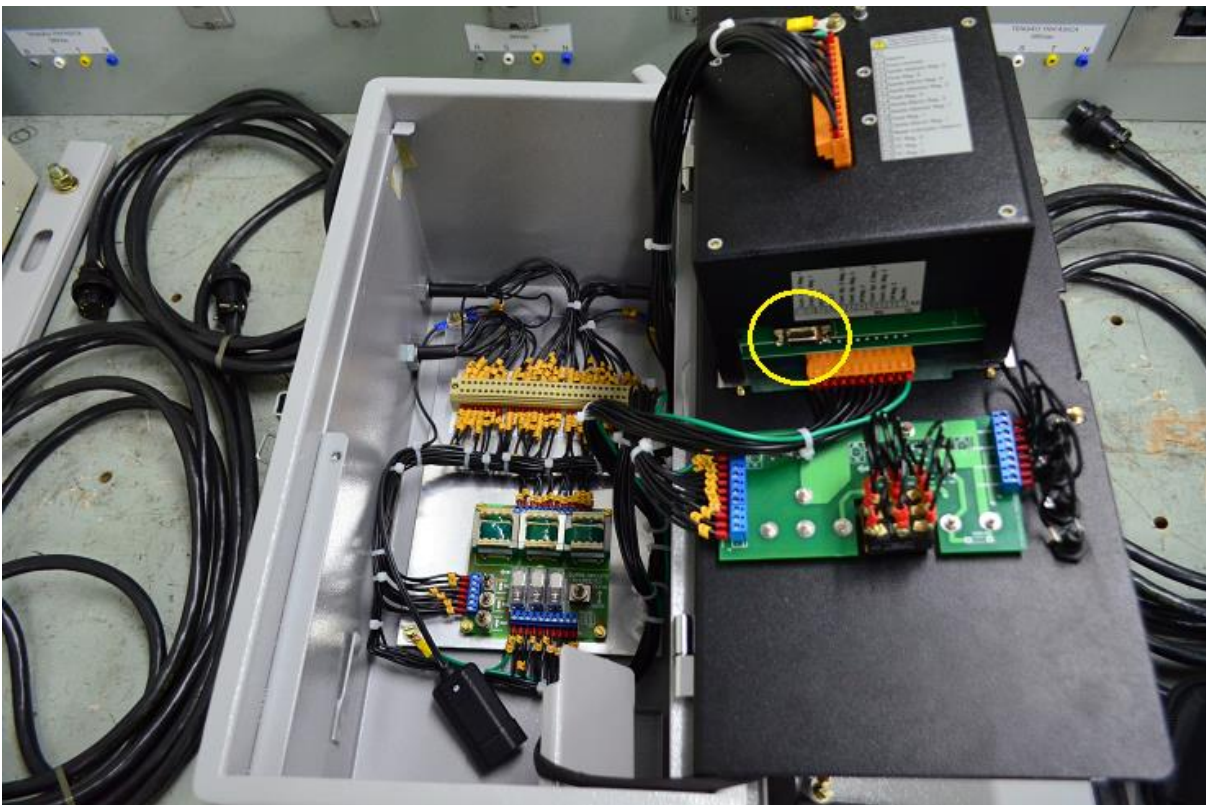
Figura 6.12 - Porta serial interna de um controle de reguladores de tensão.
