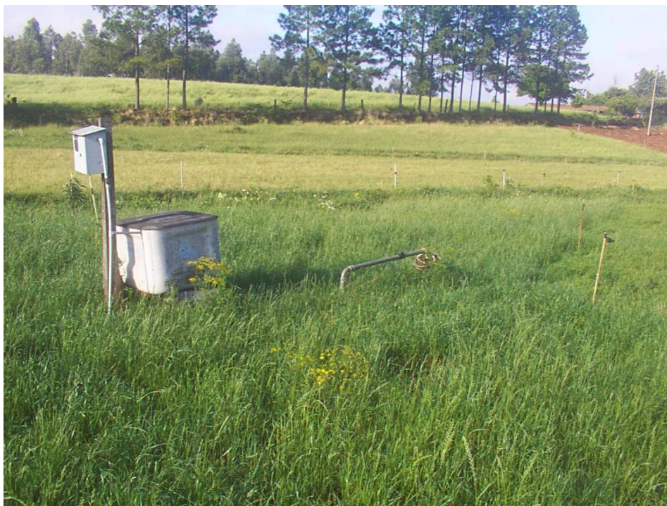
Organizado por: PASSOS, V. F. dos, 2007 Poço tubular nº. 5 da Linha Doze Sul (DS -05), ausência de laje em concreto e cercamento.
