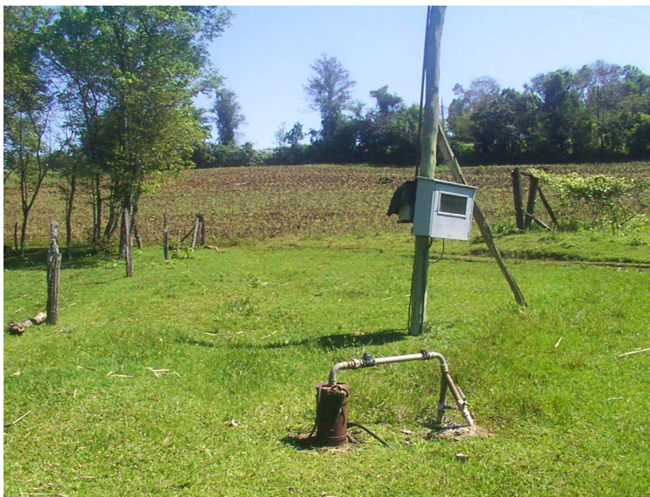
Organizado por: PASSOS, V. F. dos, 2007 Poço tubular nº. 8 da Linha Amadeu Centro/União (AC/U – 08), ausência de laje em concreto e cercamento.
