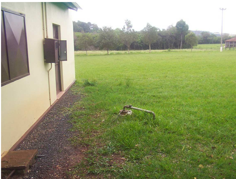
Organizado por: PASSOS, V. F. dos, 2007 Poço tubular nº. 39 da Linha Canal Torto (CT – 39), ausência de laje em concreto, instalado muito próximo da residência.
