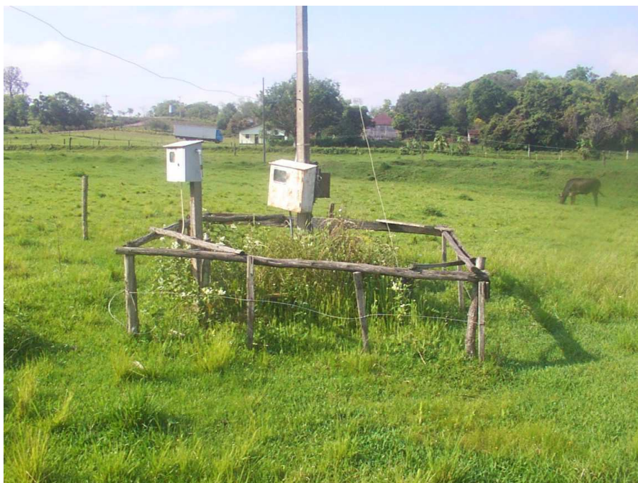
Organizado por: PASSOS, V. F. dos, 2007 Poço tubular nº. 31 da Linha Godói Centro (GC 31), ausência de laje em concreto.
