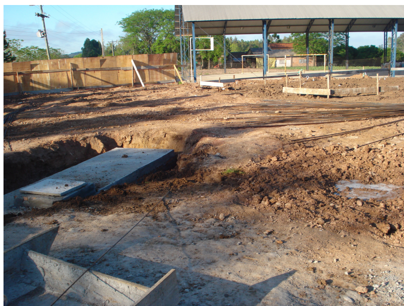
Figura 6 - Construção de fossa e sumidouro na Comunidade São José – Rincão do Pinhal/Agudo – setembro/2010
