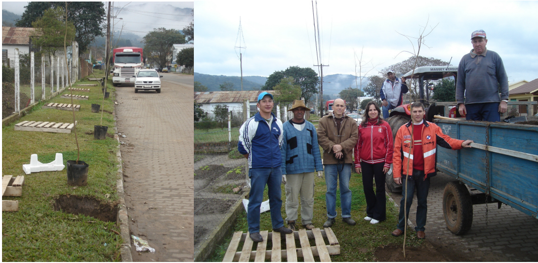
Figura 10 - Preparo das covas e plantio das mudas do Plano de Arborização de Agudo pela equipe da Secretaria da Agricultura e Meio Ambiente, Rua Voluntários da Pátria (próximo ao trevo), julho/2010
