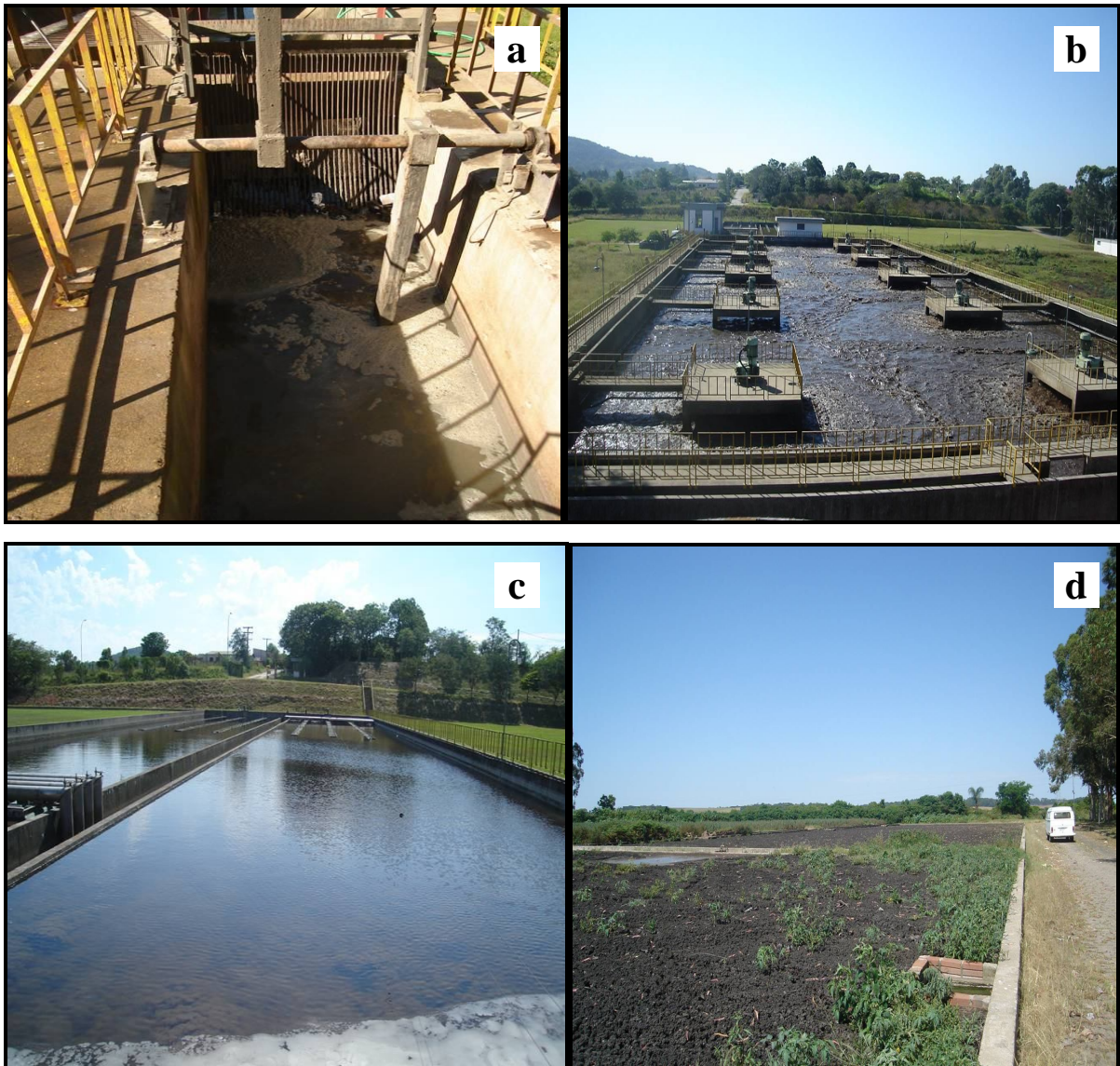
Figura 1 – Instalações da Estação de Tratamento de Esgotos de Santa Maria (ETESM), etapa de separação de detritos grosseiros (a), tratamento biológico nos tanques de aeração (b), separação de sólidos e líquidos no decantador (c) e processo de diminuição da umidade do lodo em leitos de secagem (d). Santa Maria – RS, 2008. (Foto: Guilherme Karsten Schirmer)
