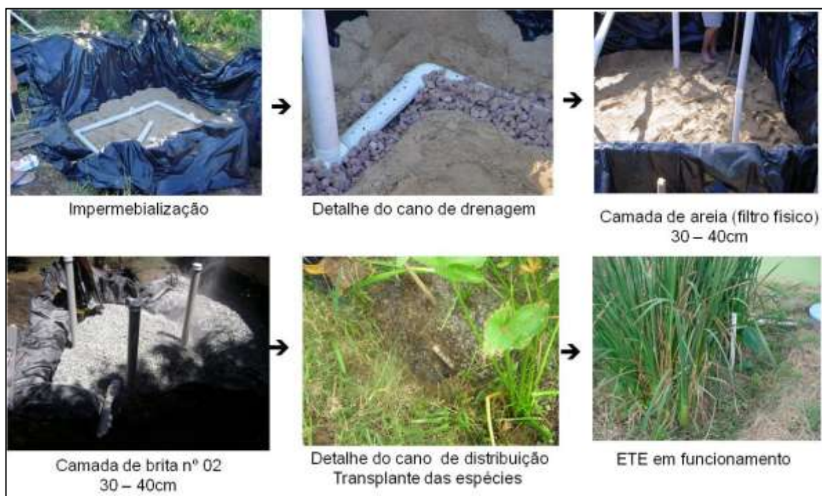
APÊNDICE F - Etapas para construção do tanque de tratamento por zona de raízes.
