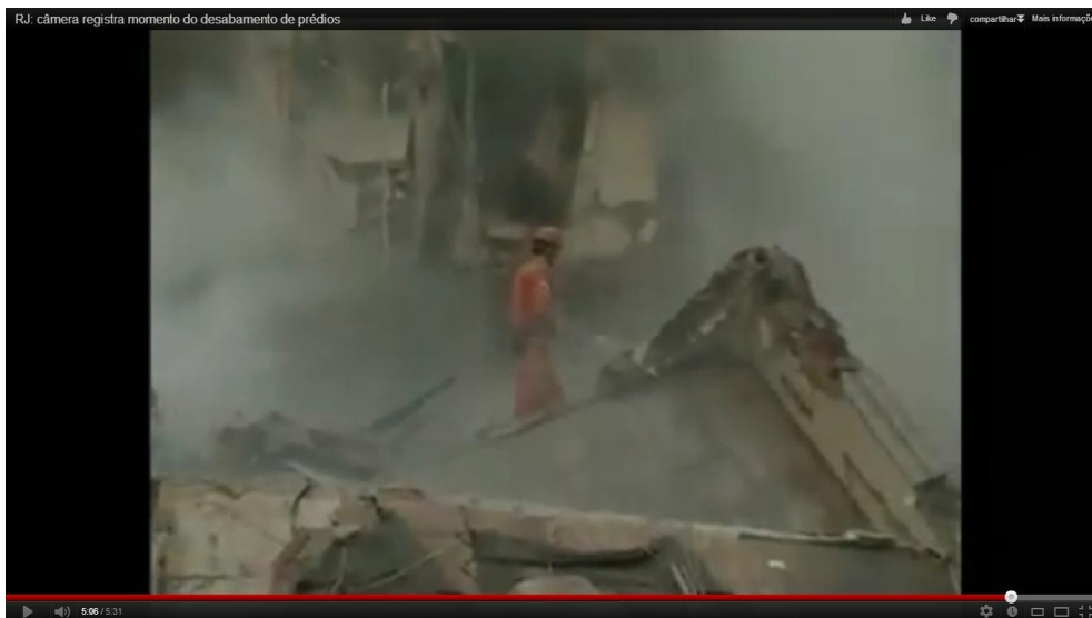
Figura 16 — escombros dos prédios e o trabalho de equipe de resgates. Fonte: Band (2012).
