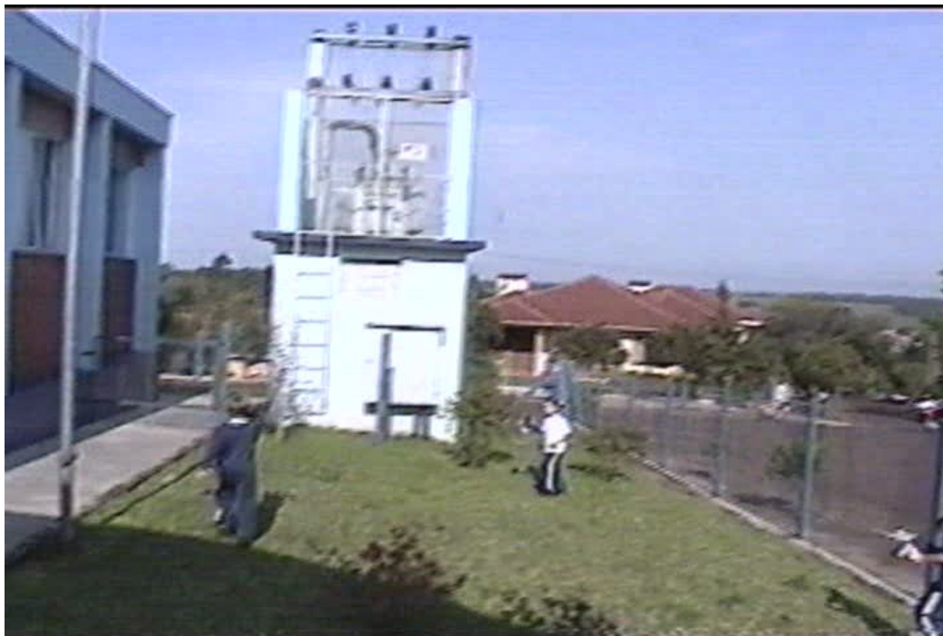
Figura 1: Foto da Área externa onde está localizado o transformador.
