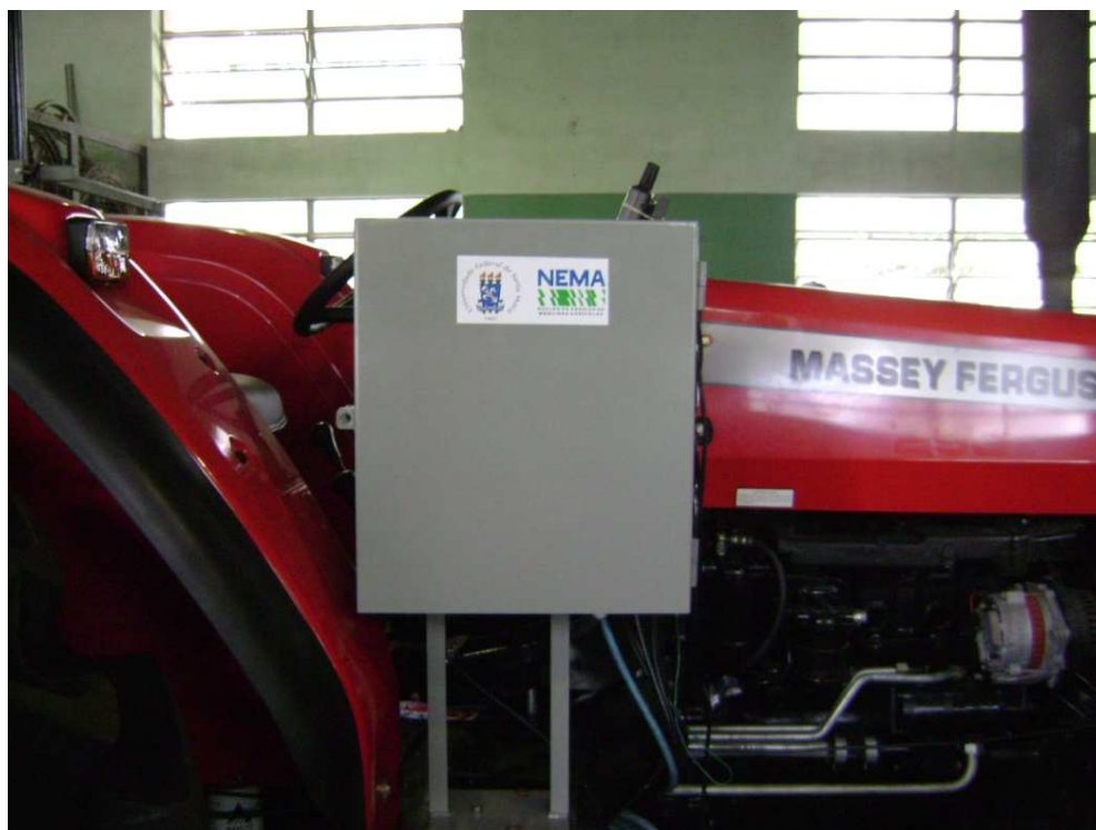
Figura 59 – Vista externa da caixa de acondicionamento do datalogger .
