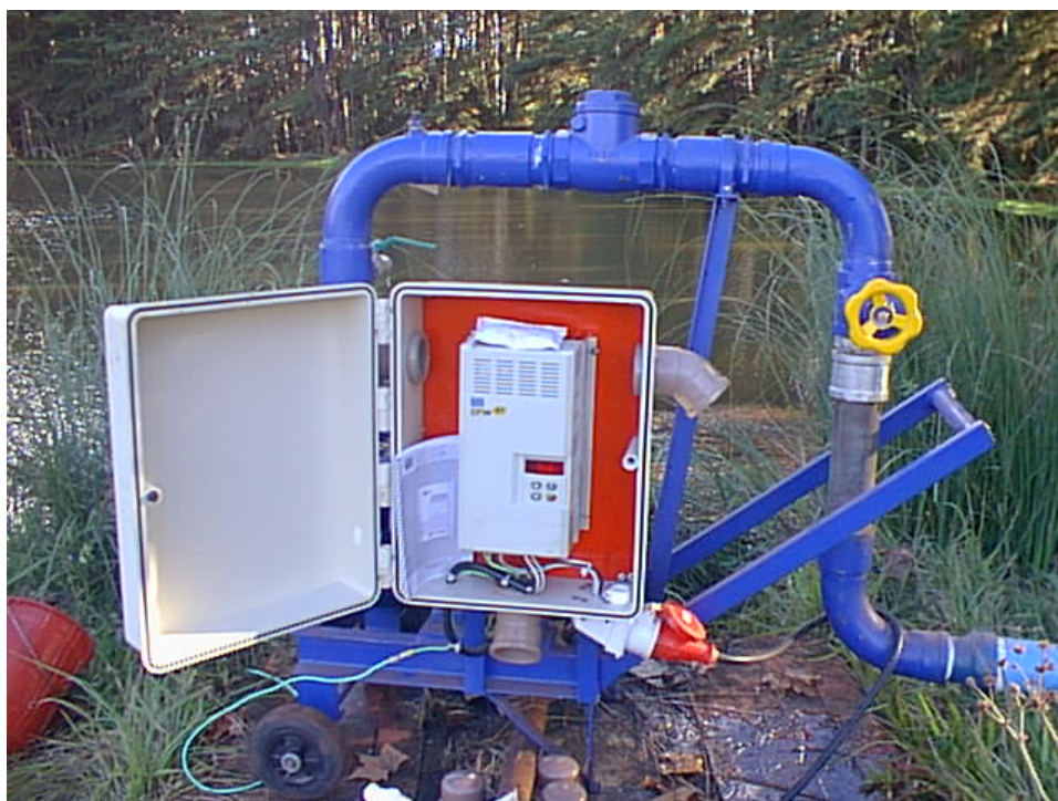
FIGURA 4 – Conjunto moto-bomba com conversor de frequência juntamente à tomada de água. Passo Fundo – RS.
