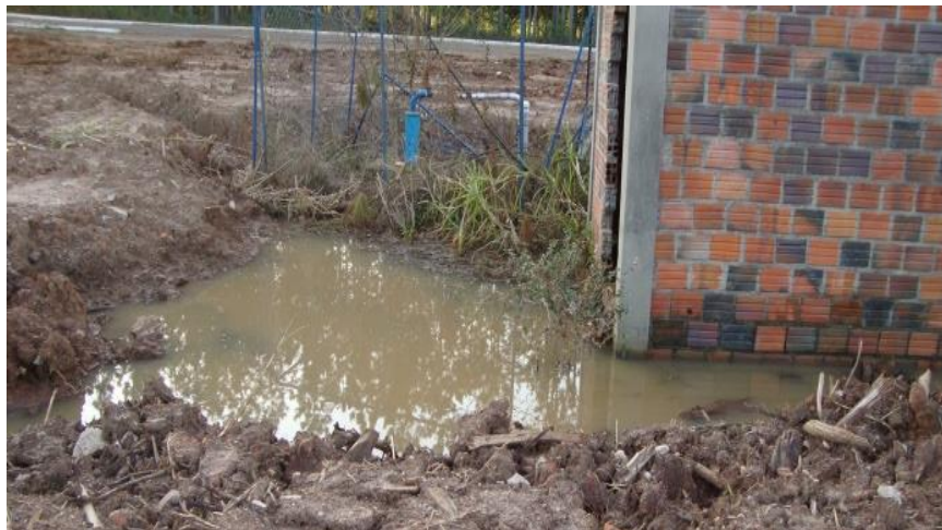
Figura 3 – Acúmulo de água da chuva em área com litologia argilosa do Membro Alemoa no Campus da UFSM, no poço PB08 Estrada do Jardim Botânico (desativado).
