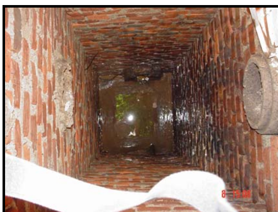
FIGURA 26. Detalhe de um dos poços de visita na região do Parque Residencial Alto da Colina
