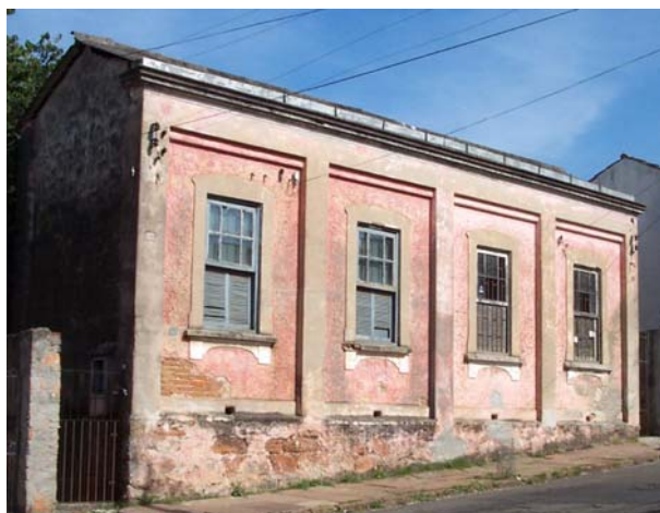
Figura 47 – Estado de conservação da edificação em outubro de 2004 (ACERVO DO AUTOR).
