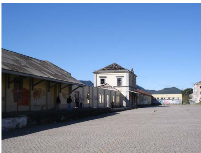
Figura 40 – Foto da estação férrea de Santa Maria em agosto de 2006: roubo das telhas da cobertura acelera processo de degradação interna (ACERVO DO AUTOR).
