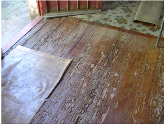
Figura 38 – Assoalho de edificação da Vila Belga atacado por cupins (ACERVO DO AUTOR).
