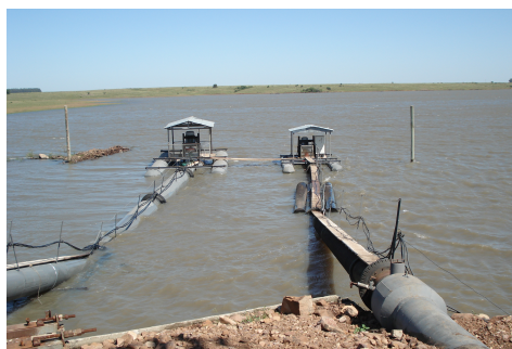
Figura 12 - Sistema de captação. Fonte: Acervo GERHI.
