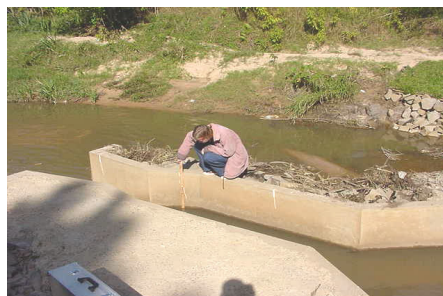
Figura 2.5 - Calha Parshall. Fonte: Acervo GERHI.
