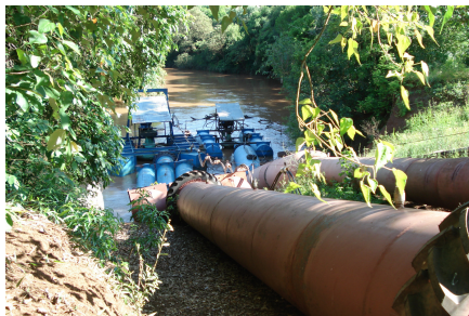
Figura 8 - Sistema de bombeamento. Fonte: Acervo GERHI.
