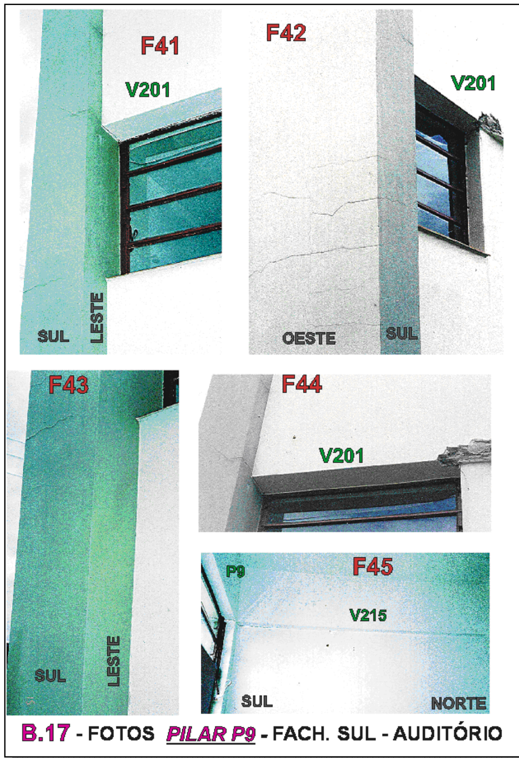
Figura 4.5 – Fotos de fissuras manifestando-se no pilar P9, fachada sul do auditório (ISAIA, 2001, p. 60)
