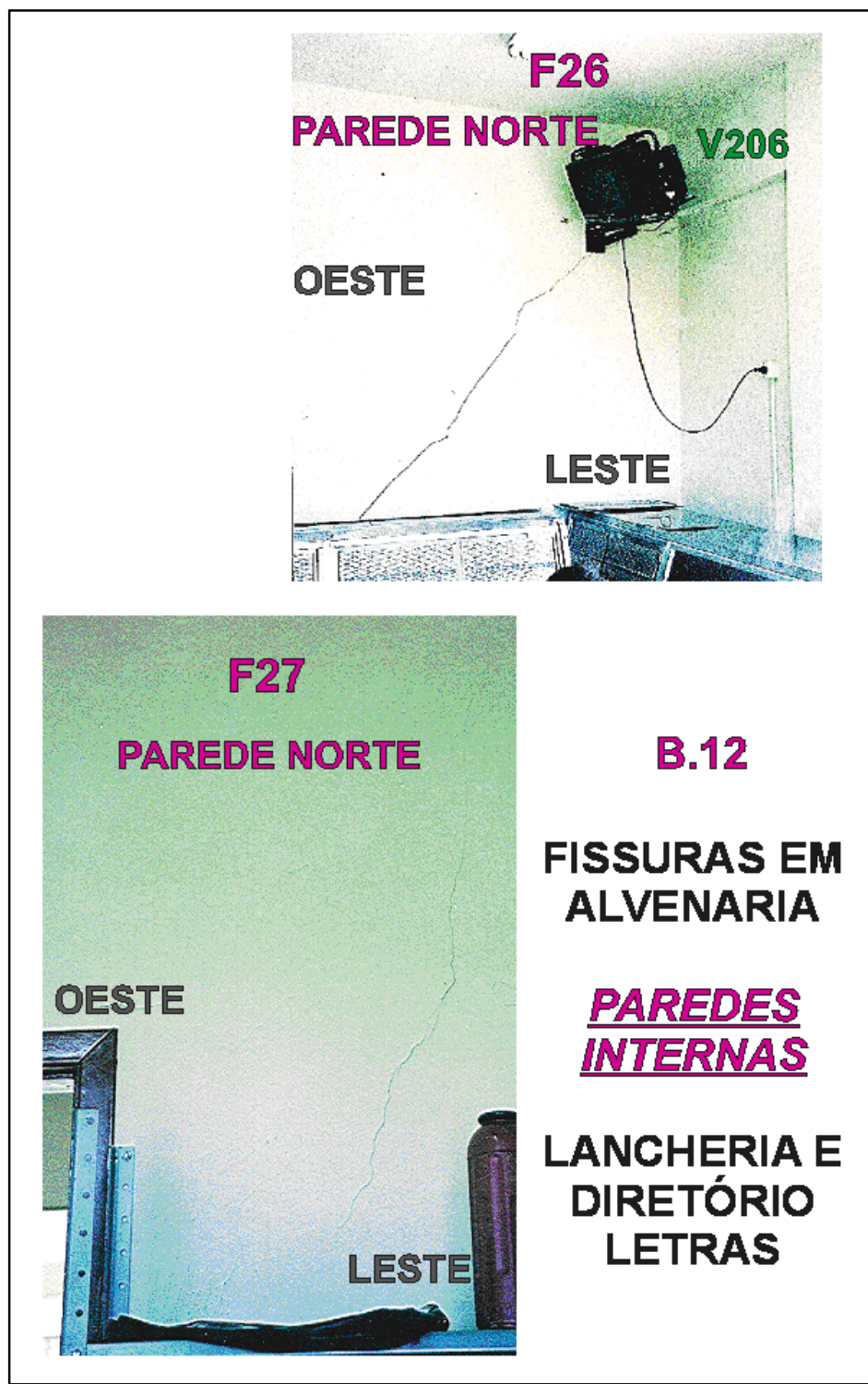
Figura 4.9 – Fotos de fissuras manifestando-se em paredes internas de alvenaria na lancheria e Diretório de Letras (ISAIA, 2001, p. 55)
