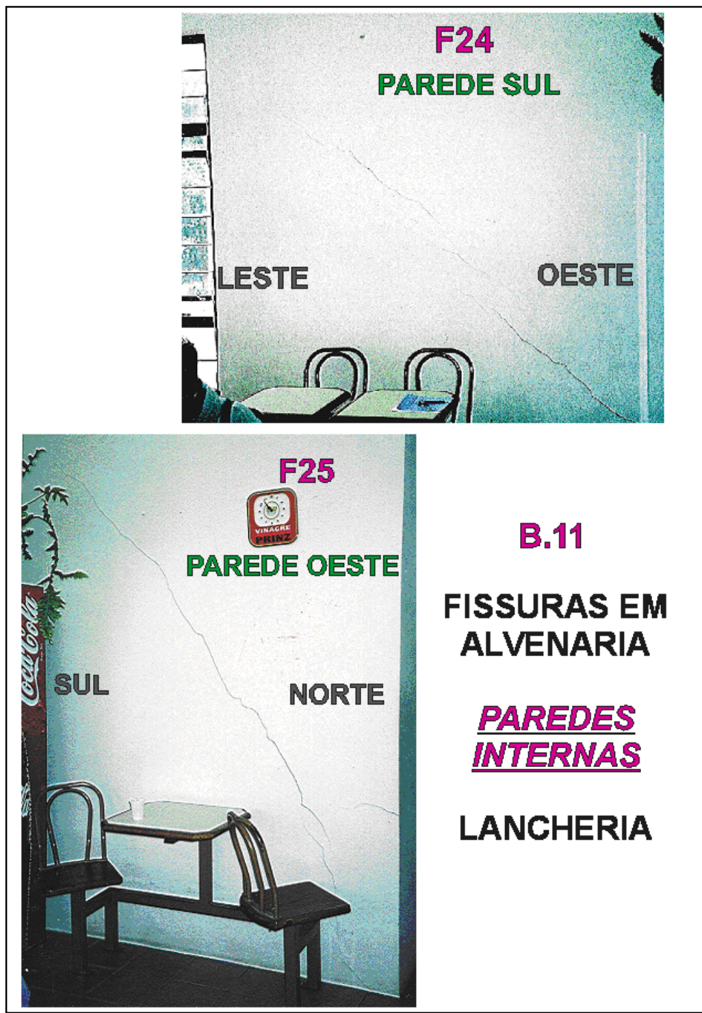
Figura 4.8 – Fotos de fissuras manifestando-se em paredes internas de alvenaria na lancheria (ISAIA, 2001, p. 54)
