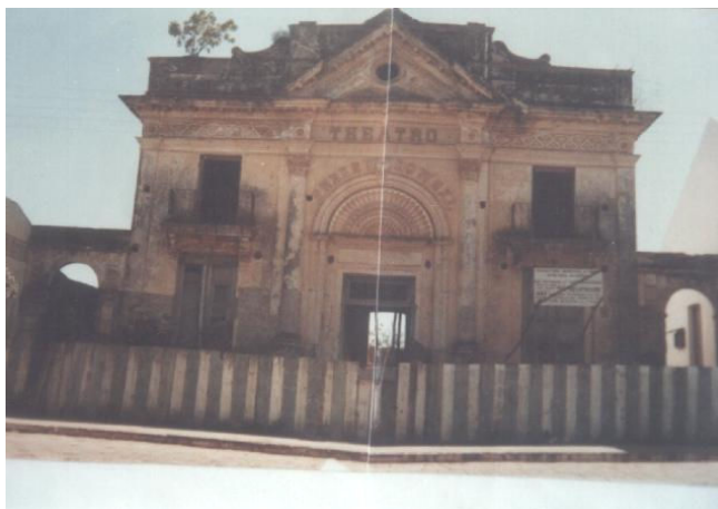
Figura 1- Edificação atacada por diversos tipos de biodeteriorações. (acervo do autor)
