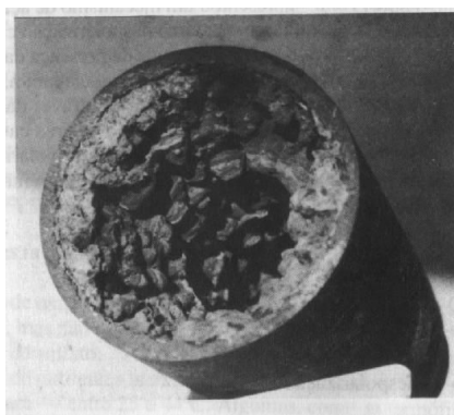
Figura 8 - Tubo de aço carbono com tubérculos de óxido de ferro.(fonte: Gentil,1996.p.96)
