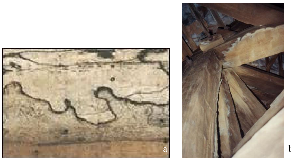
Figura 18-(a) Madeira com Podridão Branca 11 , (b) madeiramento de telhado infectado. (fonte: arquivo do autor)
