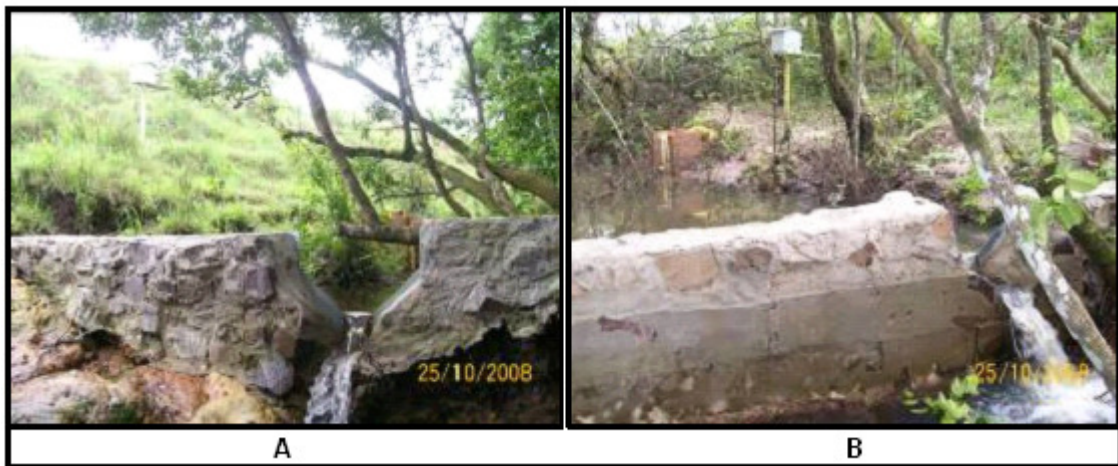
Figura 5.10 – Estrutura hidráulica com poço tranqüilizador da microbacia de campo (A) e da microbacia florestada (B), sob as coordenadas 702968 E, 6643251 S e 704445 E, 6630250 S, respectivamente.
