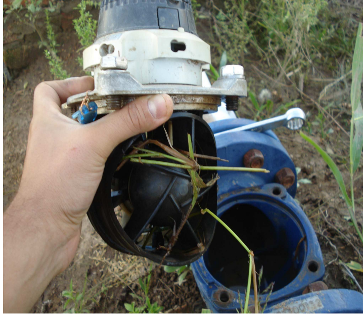
Figura 32 - Sujeira no Hidrômetro (2).
