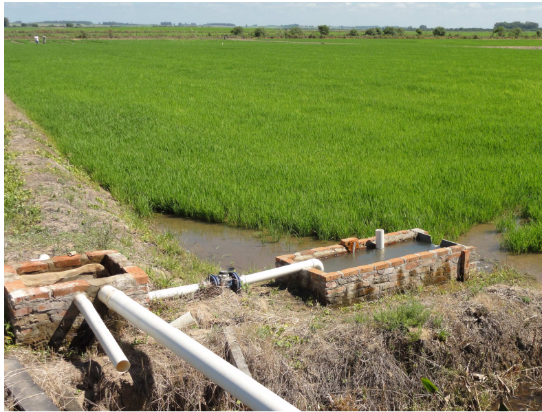
Figura 22 - Vista do hidrômetro instalado no sistema de plantio convencional
