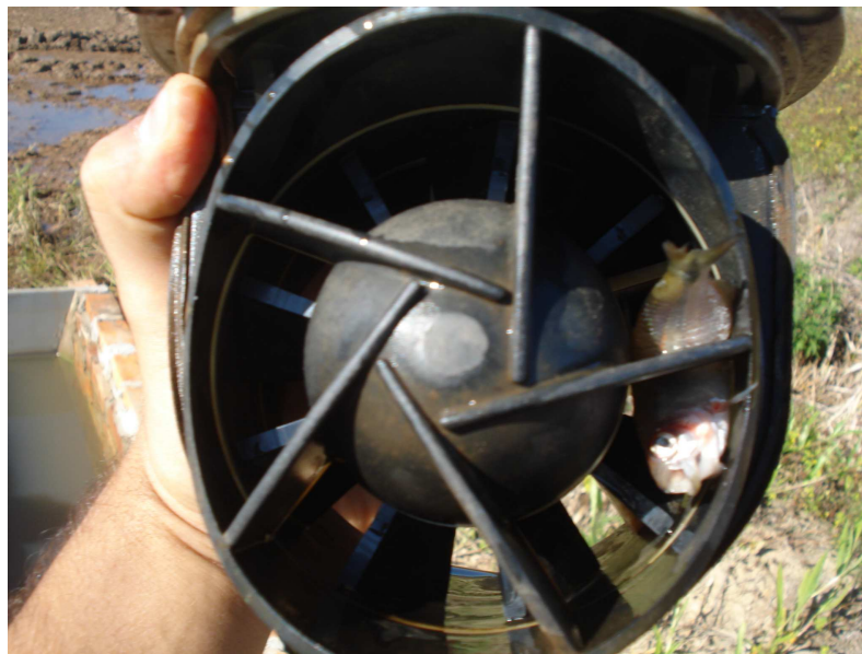
Figura 33 - Trancamento parcial do Hidrômetro (peixes)
