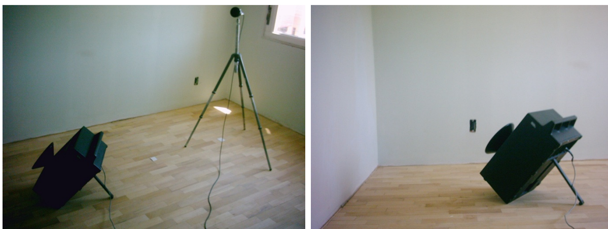
Figura 8 - Representação da montagem de equipamentos e medição da isolamento acústica de parede de alvenaria.
