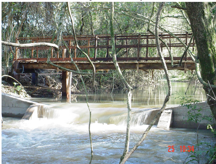
Estação de Jusante
