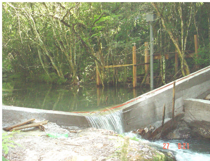
Estação de Montante
