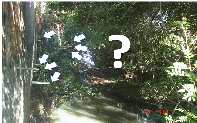
Figura 3.12 - Despejo de esgoto clandestino na rede pluvial da MU.
