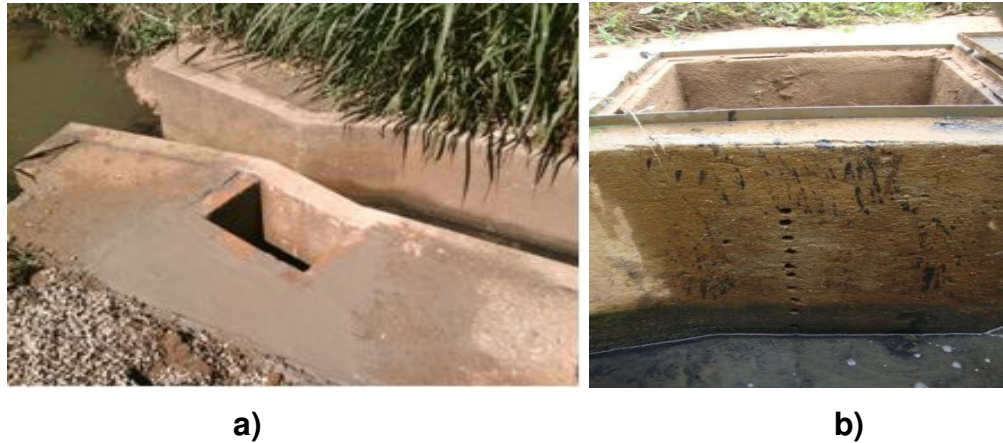
Figura 3.10 - Calha Parshall da MU. a) Poço tranquilizador b) Dutos comunicantes
