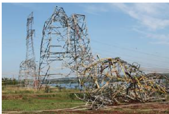
Figura 1.1 – Colapso de torres de LT sobre o rio Paraná em outubro de 2010
