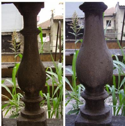
Figura 70 – Limpeza com uso de sabão e água fria – balaústres. FONTE: autora, 2011.
