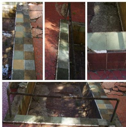
Figura 93 – Limpeza dos ladrilhos da piscina infantil após uma semana.
