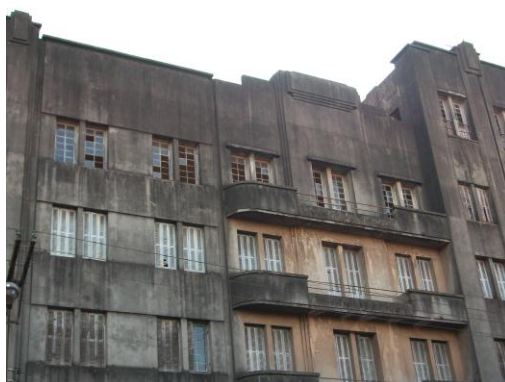
Figura 44 - Edifício Cauduro - Av. Rio Branco - Santa Maria – RS - o abandono como negligência facilitou a ação de vândalos - vidros quebrados. FONTE: acervo pessoal da autora, 2011.
