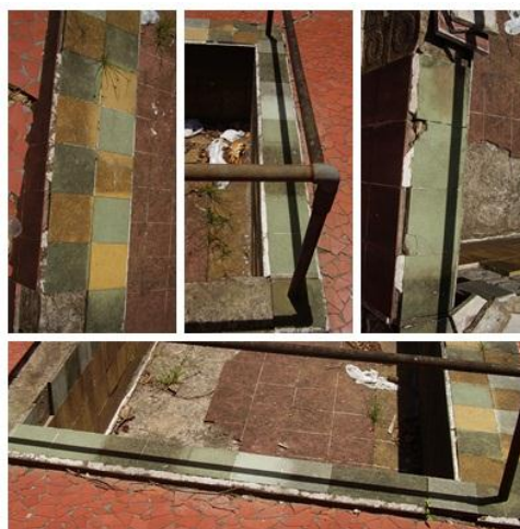
Figura 95 – Limpeza dos ladrilhos da piscina infantil após um mês. 1ª fotografia- esquerda- limpeza com água fria. Sequência do uso de produtos (de cima para baixo): água sanitária, sabão e detergente. 2ª fotografia- meio- limpeza com água morna . Sequência do uso de produtos (de cima para baixo): detergente e sabão. 3ª fotografia- direita- limpeza com água morna. Uso de água sanitária. Fotografia abaixo- geral dos ladrilhos limpos da piscina infantil. FONTE: autora, 2011.
