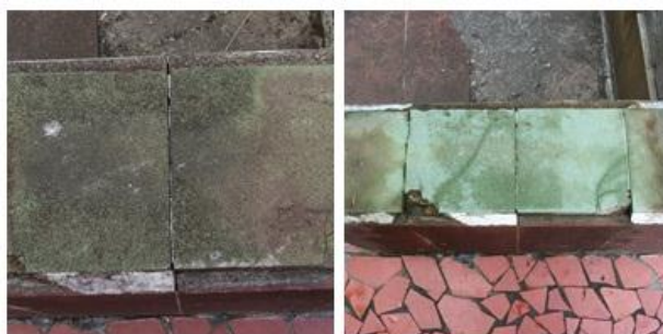
Figura 89 – Limpeza com uso de água sanitária e água morna – ladrilhos da piscina infantil. FONTE: autora, 2011.
