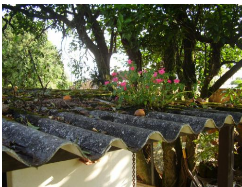
Figura 42 - Vegetação com crescimento espontâneo em telhado. FONTE: acervo pessoal da autora, 2011.
