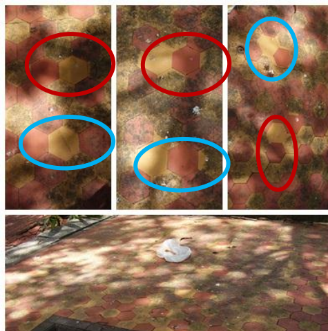
Figura 96 – Limpeza dos ladrilhos dos platôs após um mês.
