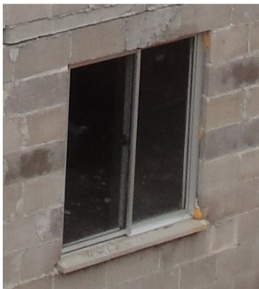
Figura 14 - Peitoril pré moldado em concreto e janela sem proteção solar.
