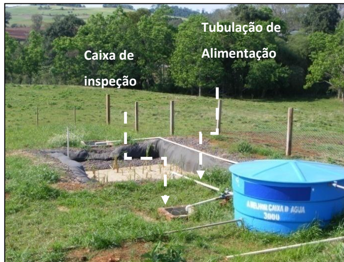
Figura 15 – Reservatório equalizador e caixa de inspeção de vazão.
