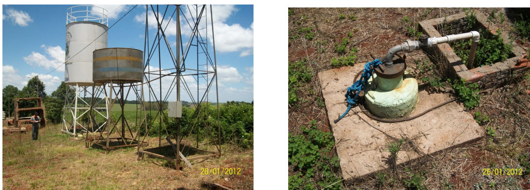
Figura 30- Poço P08 (Localidade de Parque Rodeio). Cota altimétrica de 375,00m. SASG.
