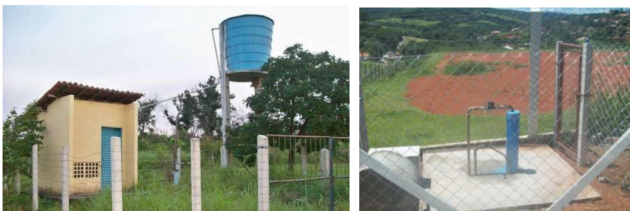
Figura 03- Exemplo de cercamento do local onde estão instalados poços tubulares, de acordo com a NBR-12.212/2006. Fonte: (Prefeitura de Cristalândia / PI, 2011).
