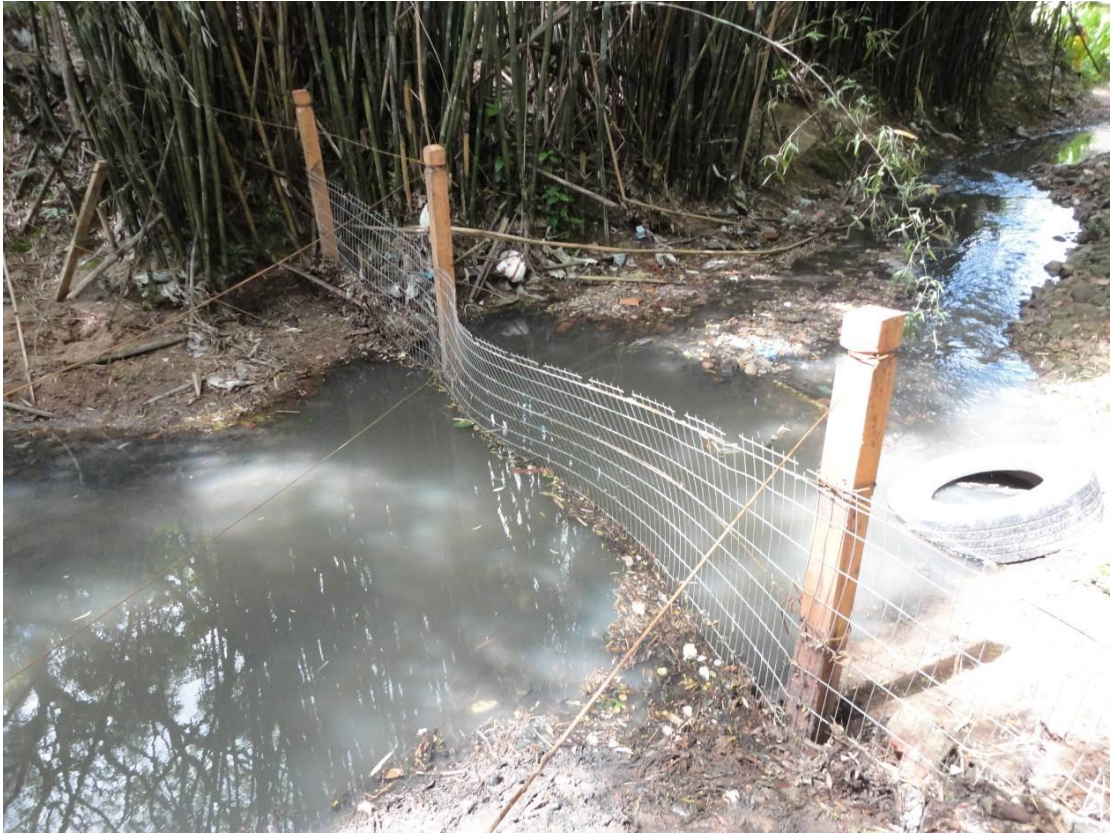
Figura 13 – Estrutura de retenção de resíduos sólidos instalada no Arroio Cancela
