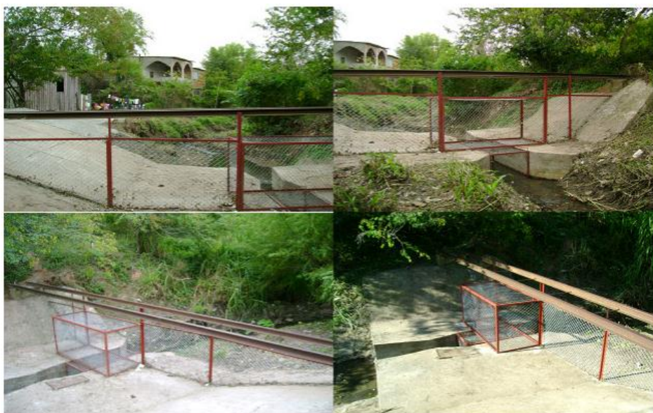
Figura 8 – Estrutura de retenção dos resíduos sólidos veiculados no arroio esperança em diferentes ângulos Fonte: Salles (2010).
