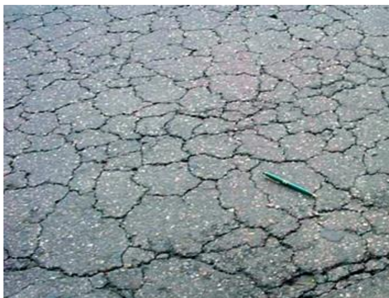
Figura 19 – Revestimento em avançado grau de fissuração
