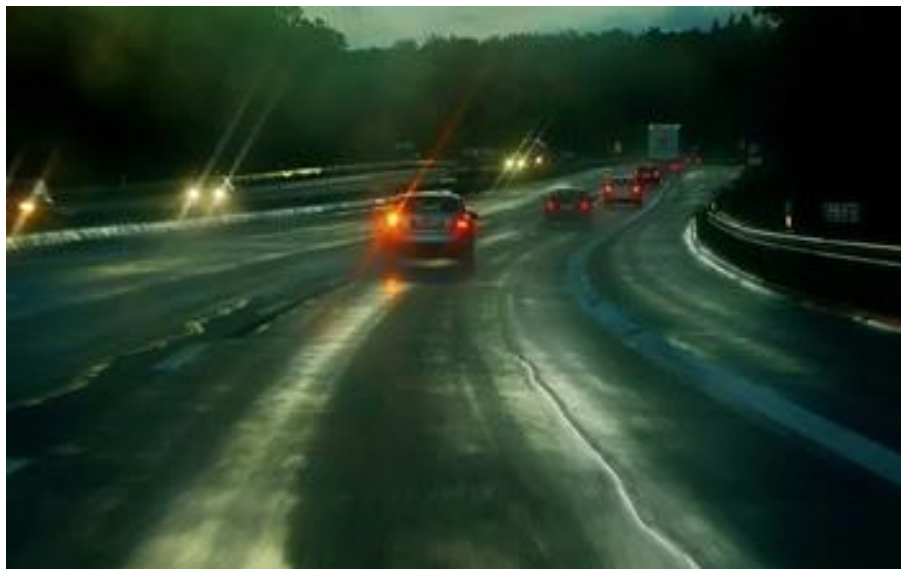
Figura 18 – Afundamento em trilha de roda com presença de água na superfície
