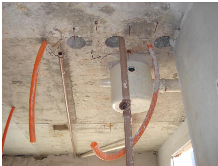
Figura 2.12 – Sistema de instalação hidrossanitário fixado sob a laje.
