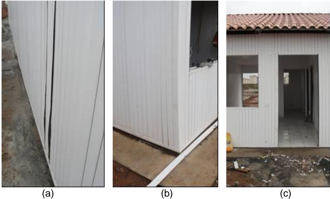
Figura 37 – Desaprumo dos fechamentos em PVC: (a) abaulamento não corrigido, (b) falta de prumada nos cantos; (c) vãos de aberturas fora de esquadro.
