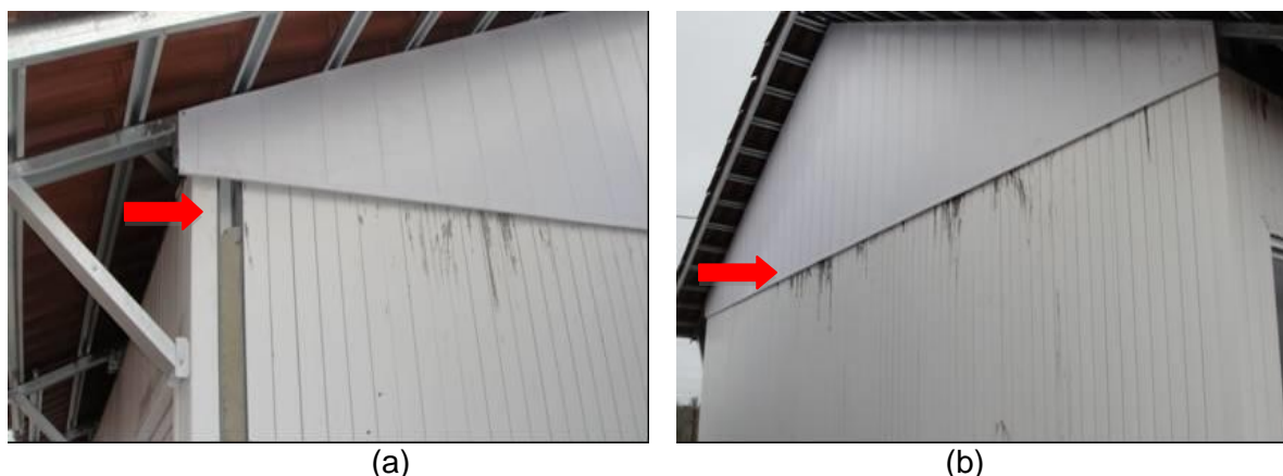
Figura 36 – Falhas no preenchimento dos perfis: (a) formação de vazio ; (b) transbordamento de concreto na superfície da parede.
