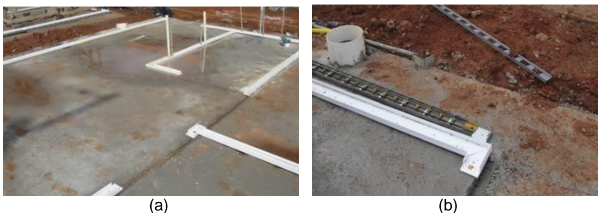
Figura 27 – Canaletas: (a) fixação sobre a fundação nos locais onde ficarão as paredes; (b) detalhe do desnível para não entrada das águas.
