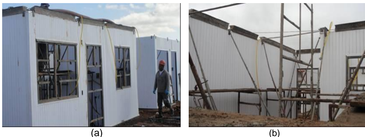
Figura 34 – Concretagem: (a) no alto, mangueiras conduzindo o concreto; (b) interior da edificação mostrando as calhas para despejo do material e andaimes.
