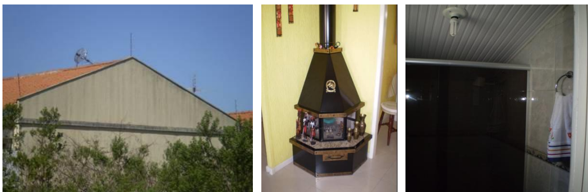
(a) (b) (c) Figura iii – (a) oitão com fissuras; (b) lareira implantada posteriormente; (c) ampliação.
