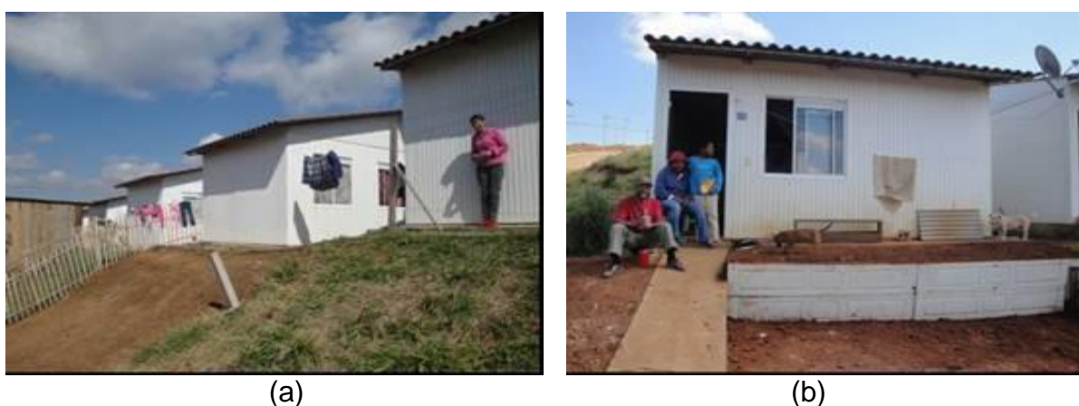
(a) (b) Figura xi – (a) mofo no oitão; (b) inclinação acentuada do terreno.
