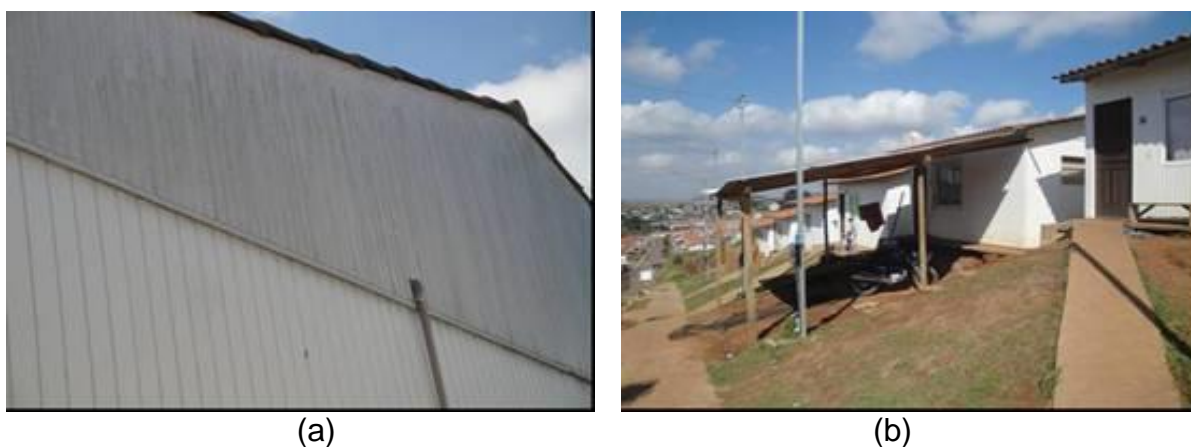
(a) (b) (c) Figura x – (a) água condensada na parede; (b) revestimentos aplicados; (c) pintura descascada.
