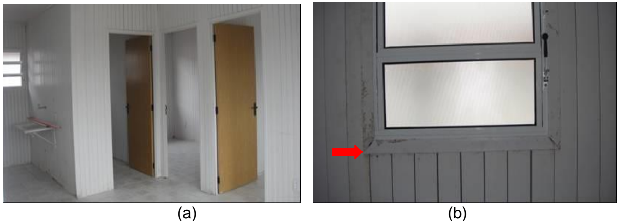
Figura 40 – Visão interna das aberturas: (a) portas de madeira; (b) alizar mal acabado.
