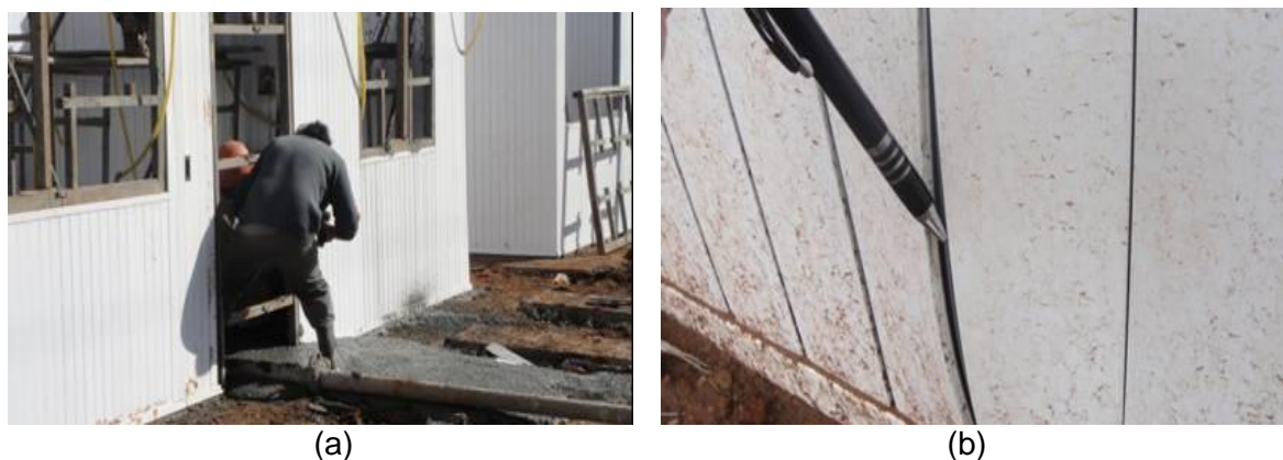
Figura 35 – Efeitos do concreto: (a) desperdício do concreto devido à quebra da peça de PVC; (b) abaulamento causado pelo acúmulo do material.
