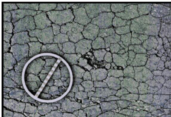
Figura 11- Pavimento degradado por fadiga-trinca interligada-tipo jacaré
