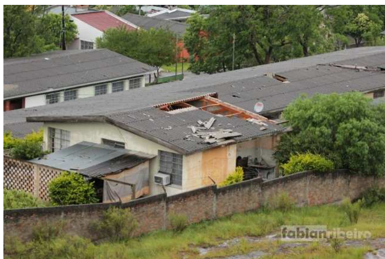
Figura: Cobertura danificada em Escola.
