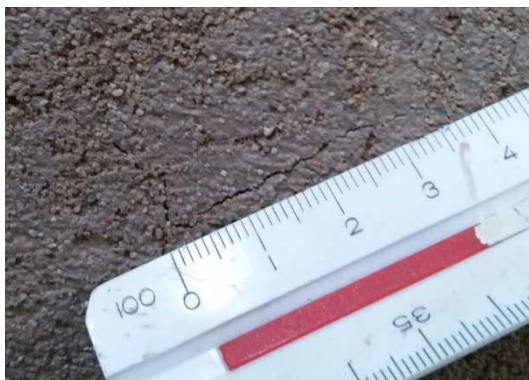
Figura 58 - Fissura na argamassa 30%CF com 1dia
