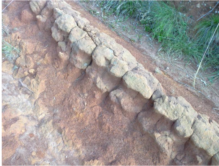
Figura 4.5 - Presença de crosta devido à compactação pela passagem dos blindados (PITTELKOW, 2013)
