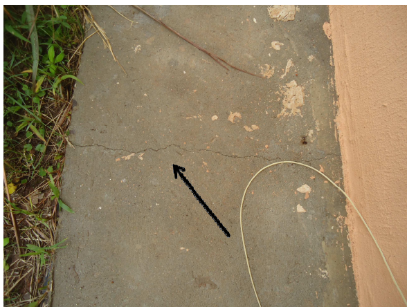
Figura 76 – Fissura no radier, com início ao leste da edificação.
