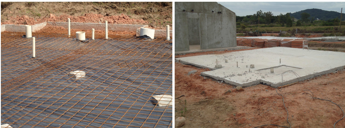
Figura 17 – Radier de uma edificação popular.
