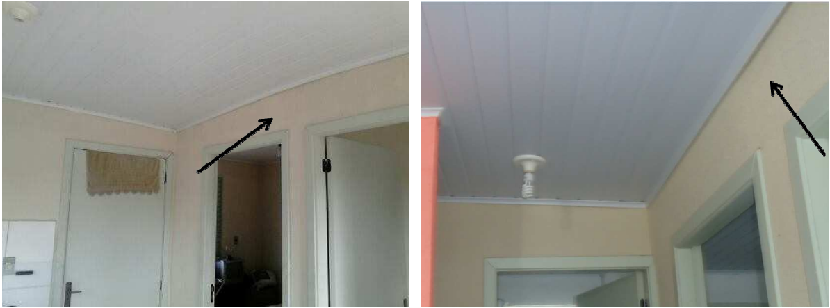
Figura 89 – Rodaforro deslocado das paredes da sala de estar.
