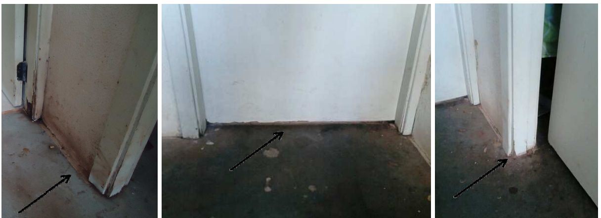
Figura 88 – Problemas encontrados nos marcos dos dormitórios e banheiros.
