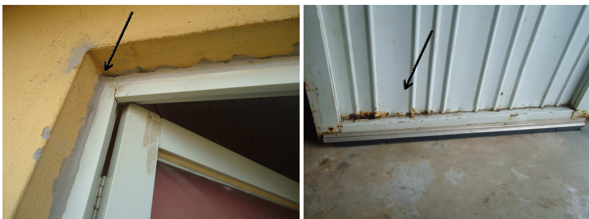
Figura 85 – Problemas na porta da sala de estar.
