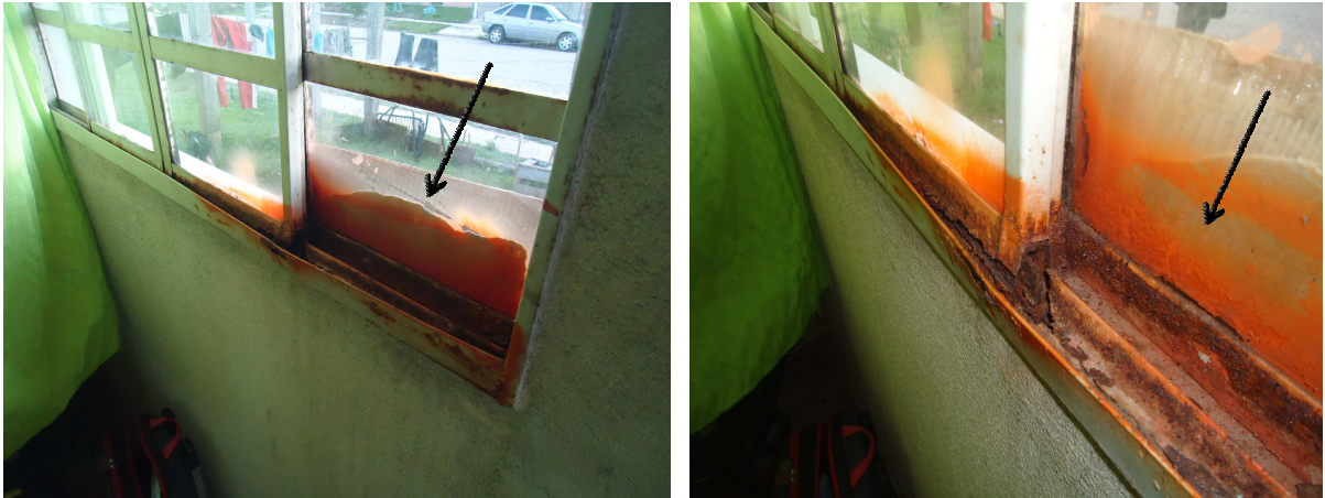
Figura 86 – Esquadria da sala de estar completamente corroída.
