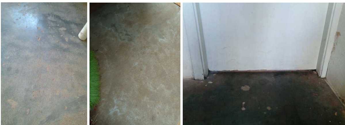
Figura 80 – Fissuras e desgaste no piso cimentado das unidades habitacionais.
