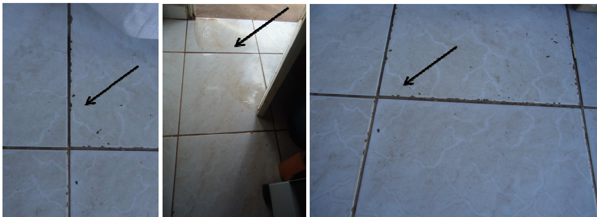
Figura 81 – Fissuras e desgaste no piso cerâmico original das unidades.
