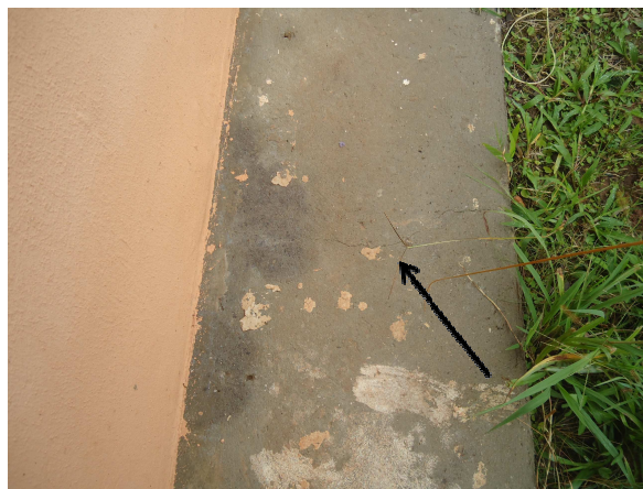
Figura 77 – Fissura no radier, com fim ao oeste da edificação.
