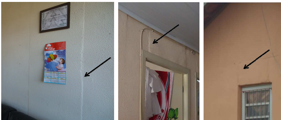
Figura 82 – Marcas das fôrmas de concreto salientes nas paredes.
