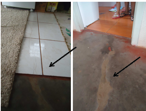
Figura 78 – Fissura no piso.
