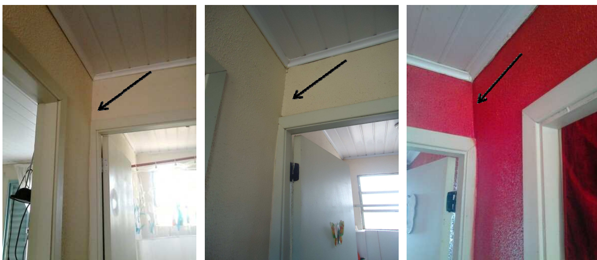
Figura 84 – Problema relacionado ao esquadro, identificado na circulação.
