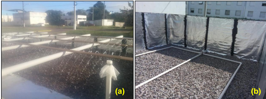
Figura 16 - Tubulações de distribuição (a) e de drenagem de efluente (b).
