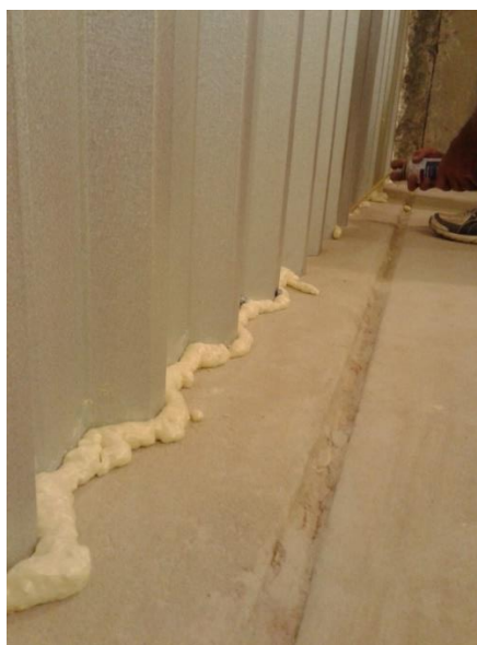
Figura 46 – Processo de preenchimento do perímetro das telhas com espuma expansível de poliuretano.
