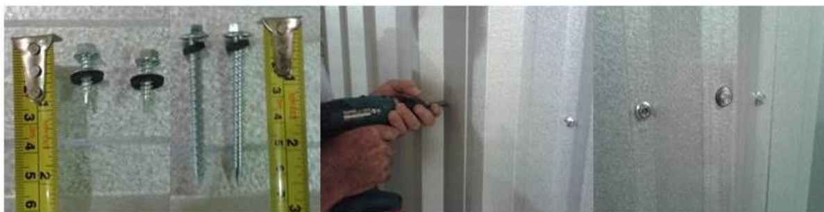
Figura 45 – Processo de fixação com parafusos de fixação e costura respectivamente, e aspecto final.
